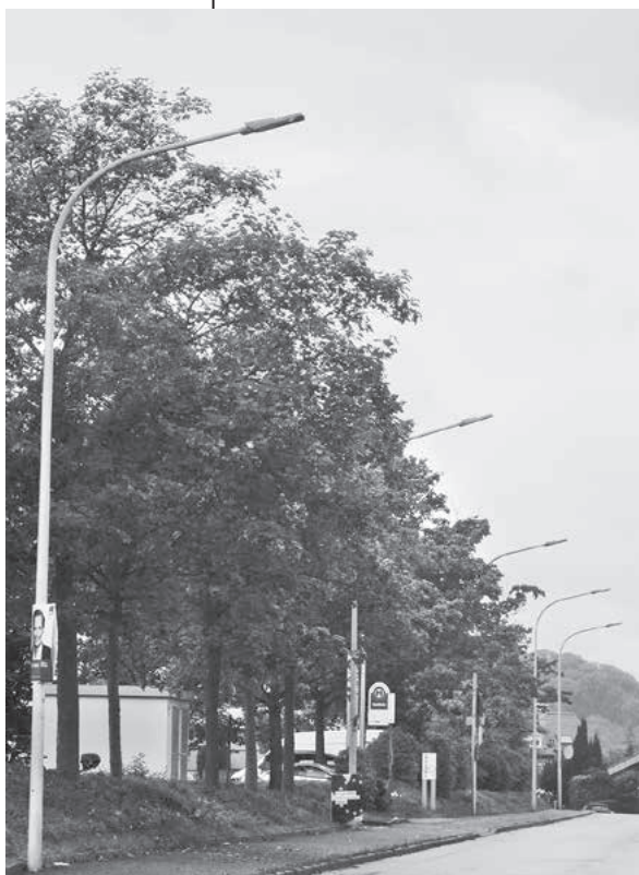
Bereits 2017 wurden die Hauptachsen im Dorf auf LED umgestellt.
