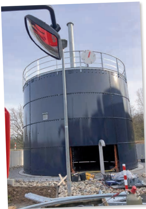
Der Gasbehälter speichert das Gas fürs das Blockheizkraftwerk in der Kläranlage
