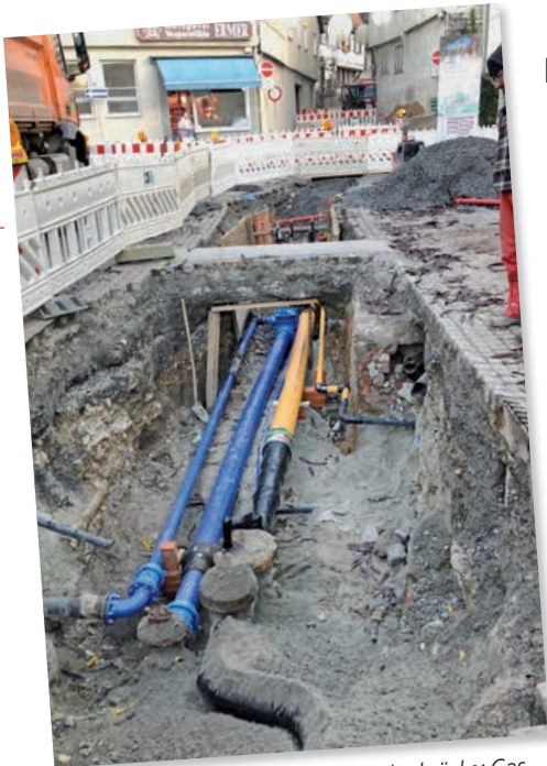
Von der B 27 Brücke in die Alte Neckarbrücke: Gas und Wasser für das „Dorf“
