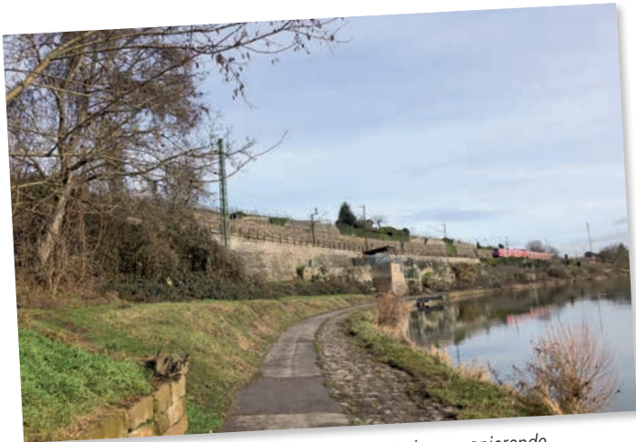
Oberhalb der Schiffsanlegestelle – die von der Bahn zu sanierende Stützmauer.
