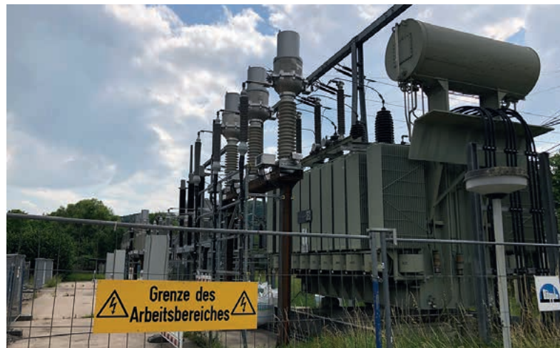
Künftig wegfallend: Umspannwerk als Freiluftanlage
