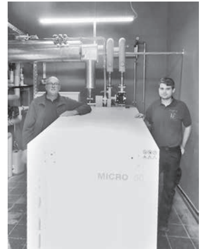
Die stolzen Betreiber des BHKWs auf der Kläranlage, der Leiter der Kläranlage, Abwassermeister Bernd Modjesch und sein Kollege Abwassermeister Thomas Hammer
