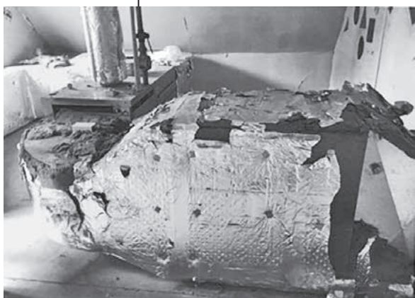
Alte Lüftungs- und Heizungsanlage
