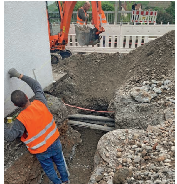
Unbekannte Kabel queren die Baugrube.
