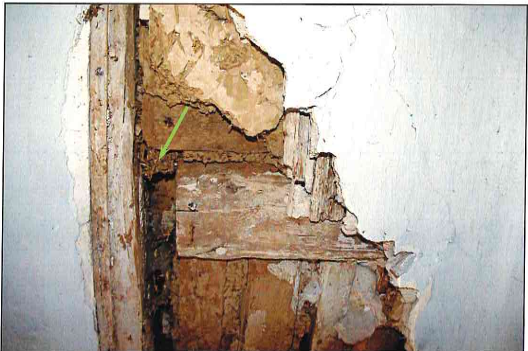
Abb. 23: Gelöste Zapfenverbindung am Deckengebälk (Pfeil).
