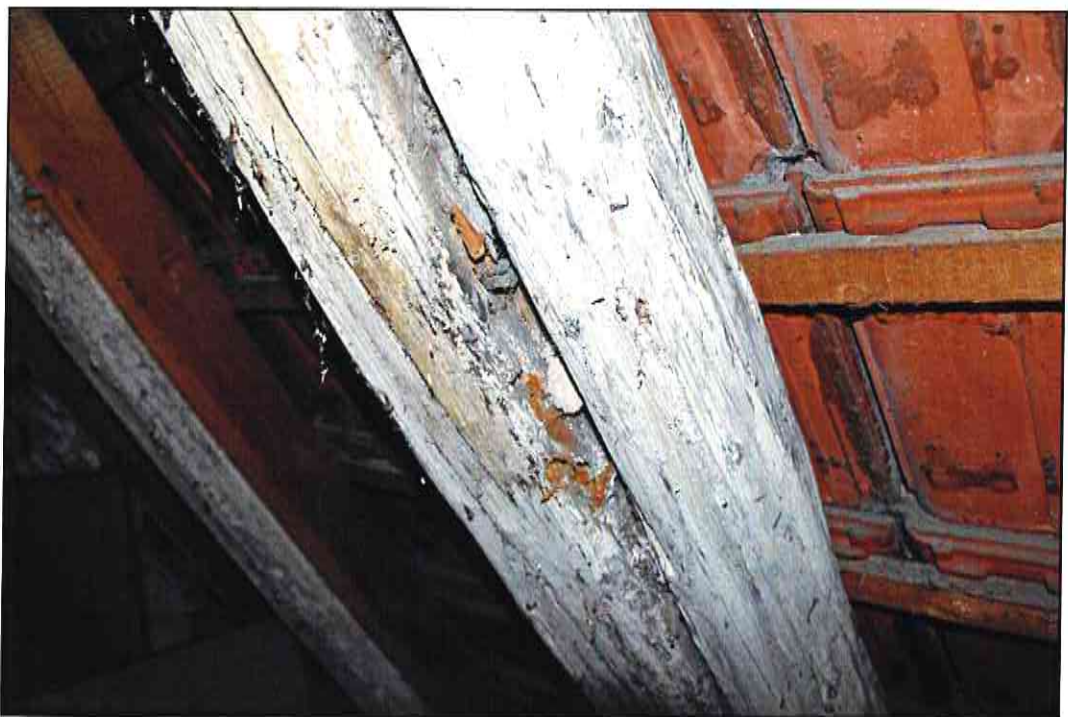
Abb. 48: Seitliche Kantholzverstärkung an Sparren mit Pilz- und Insektenschäden (Nr. 11, östliche Dachhälfte).
