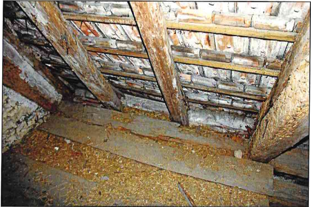
Abb. 25: Alte Pilzschäden an den Auflagerbereichen bzw. an der Stuhlschwelle. Der Längsverband fehlt (Zwischenbau).
