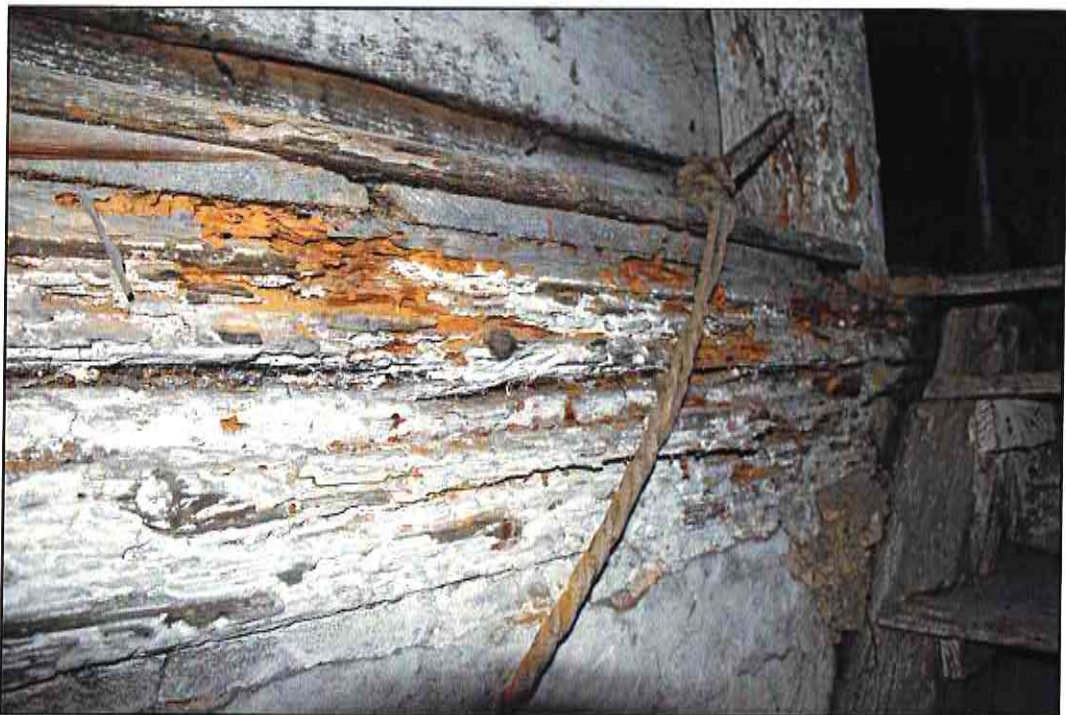
Abb. 40: Alte Hausbockfraßschäden an Kehlbalcken (Bindergespärre 13).
