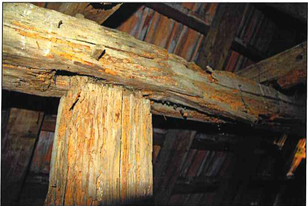
Abb. 42: Alte Hausbockfraßschäden im Dachraum des Zwischenbaus (2. Ebene).
