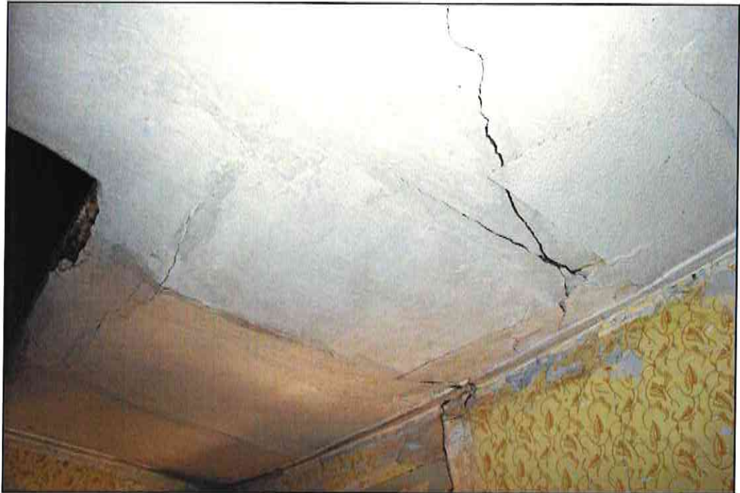
Abb. 14: Verformungen und Risse an der Deckenunterseite des Flurs unmittelbar unterhalb der darüber liegenden Dachkehle.
