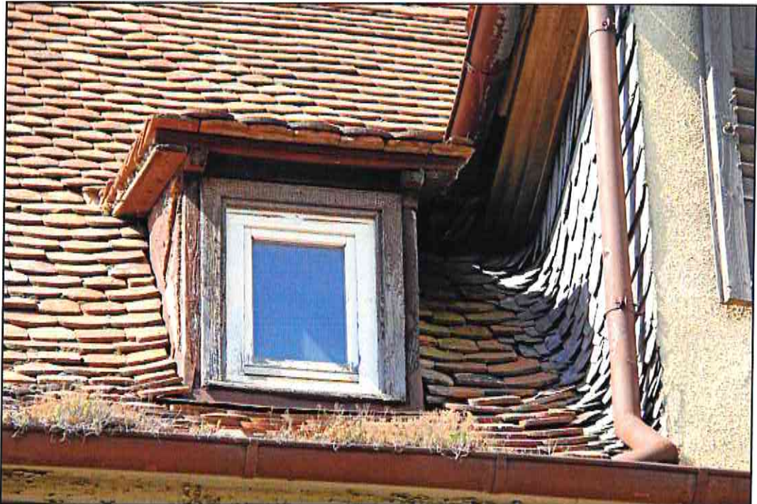
Abb. 55: Pflanzenbewuchs in Dachrinne (Traufe Straßenseite).
