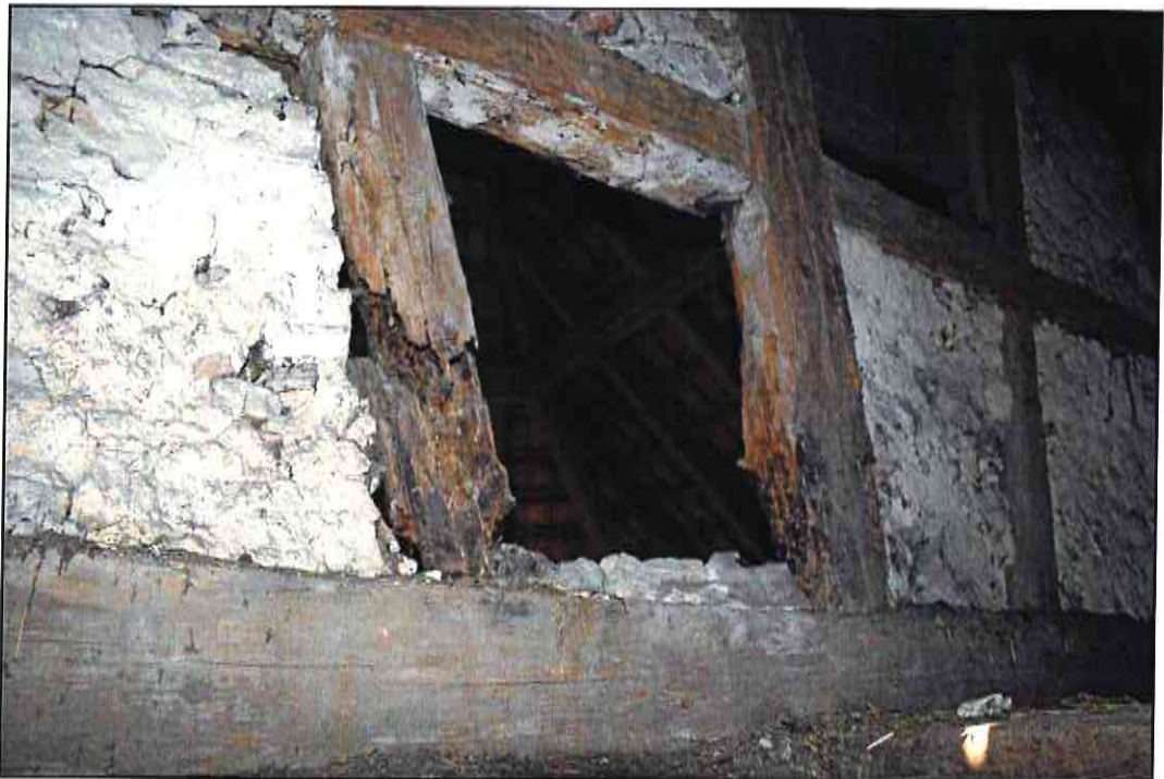
Abb. 36: Sichtbare Pilzschäden am Fachwerkgiebel, vom Dachraum aus betrachtet.
