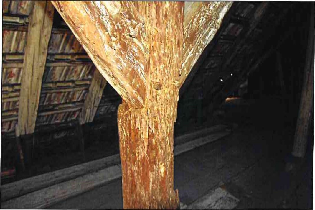
Abb. 53: Mit einem vorbeugenden öligen Holzschutzmittel behandelter Stän- der.
