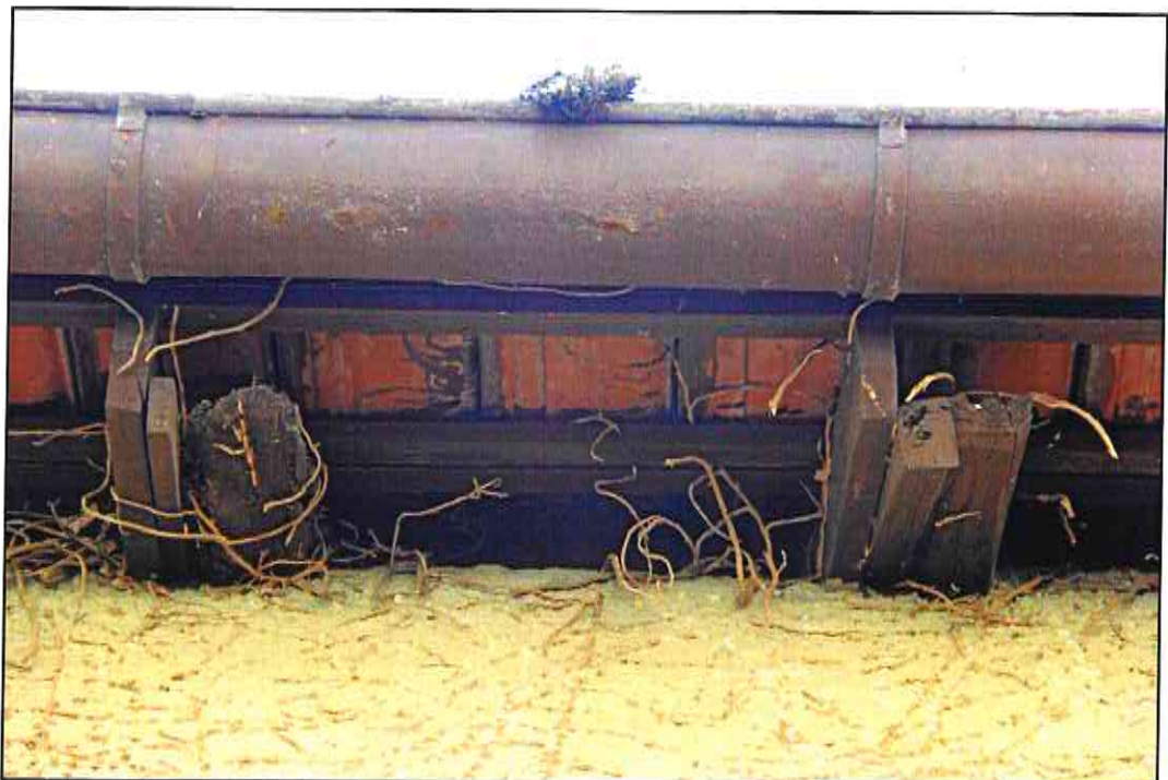
Abb. 55: Aufschieblinge mit Pilz- und Insektenschäden.
