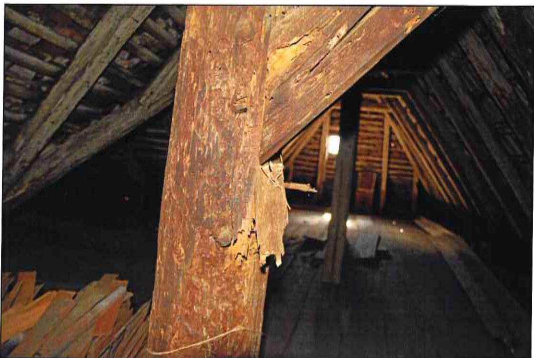
Abb. 44: Alte Hausbockfraßschäden im Dachraum des Wohnteils (1. Ebene).
