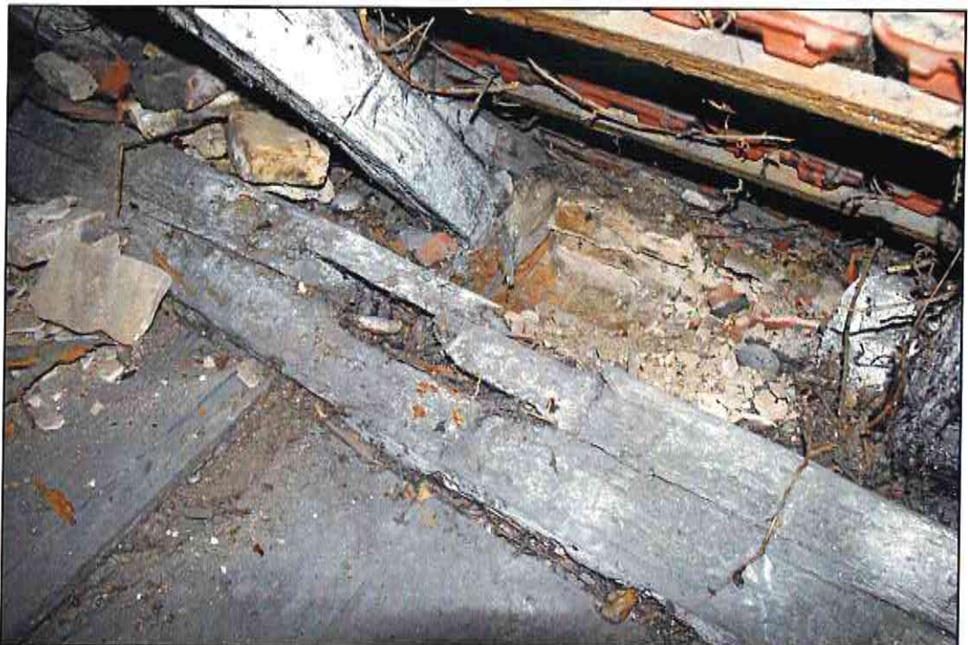
Abb. 50: Leere Zapfenlöcher eines ausgebauten Längsverbandsholzes an einer Fünfkantstuhlschwelle (Nr. 5, Traufe Osten).
