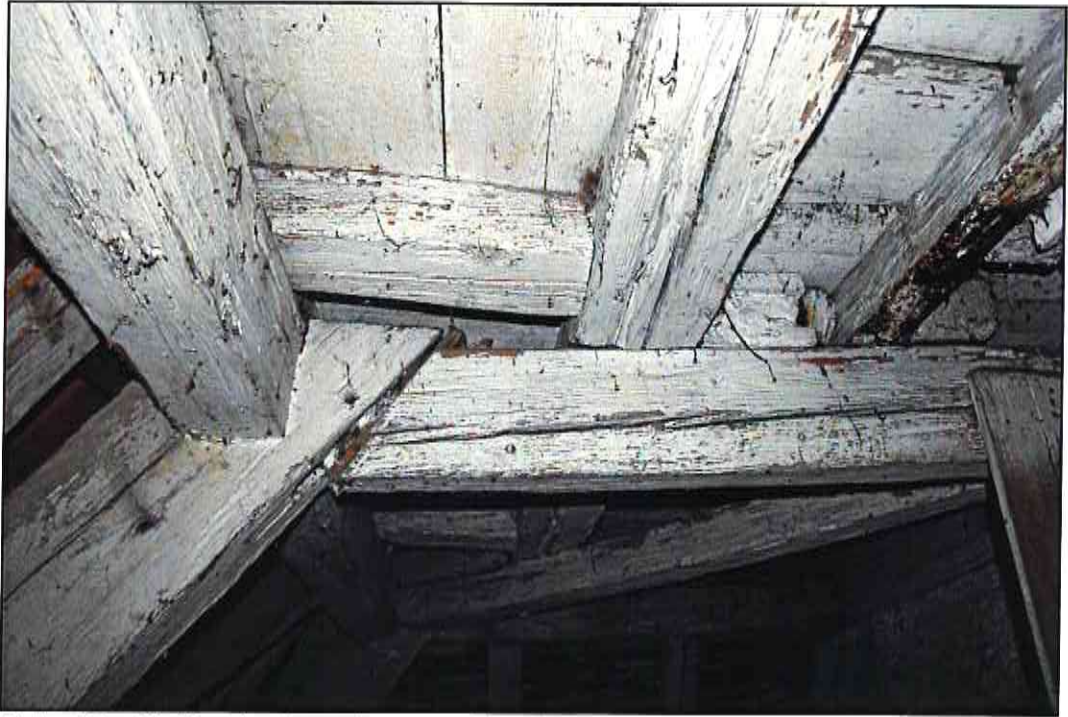
Abb. 51: Klaffende Fuge im Anschlussbereich eines Spannriegels zur Stuhlstrebe.
