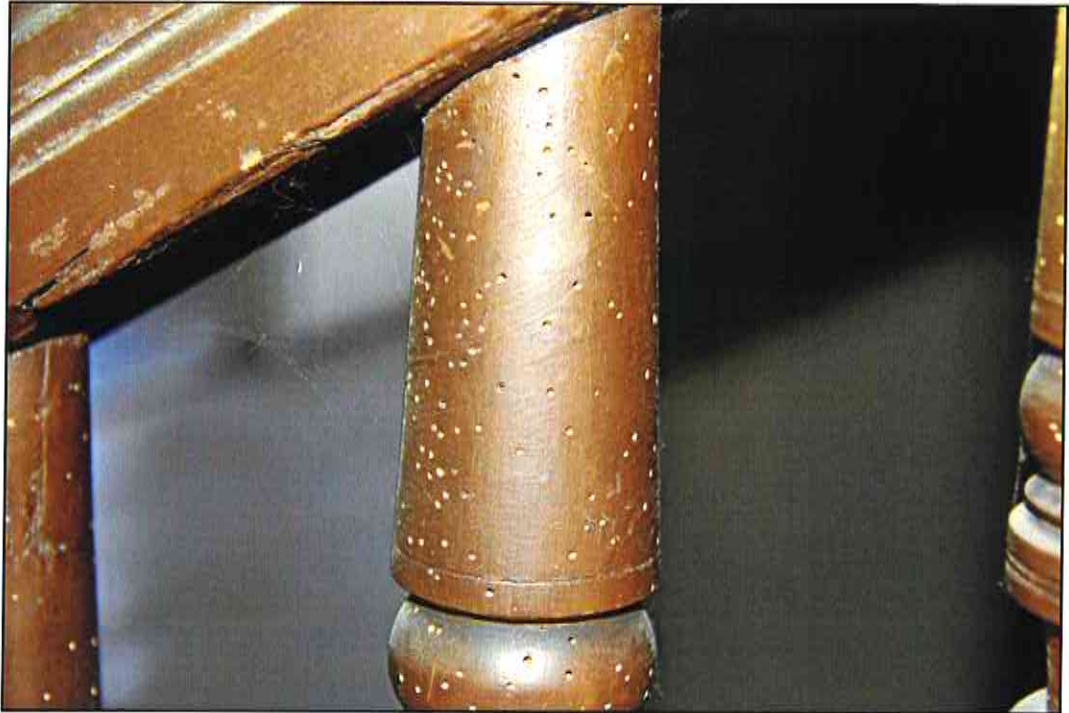
Abb. 06: Befall des Gewöhnlichen Nagekäfers.
