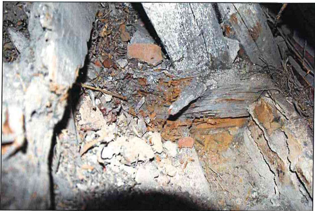
Abb. 28: Pilz- und Insektenschädigung bei Dachbalken 5 (Traufe Osten).
