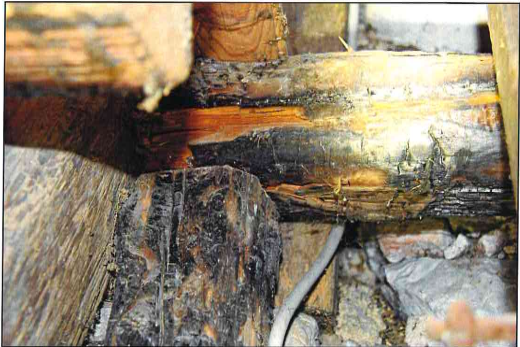
Abb. 13: Brandspuren an verschiedenen Holzbauteilen.
