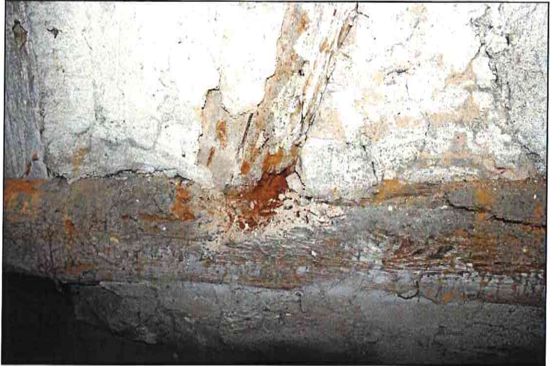
Abb. 10: Schadhafte Fachwerkhölzer an Trennwand.
