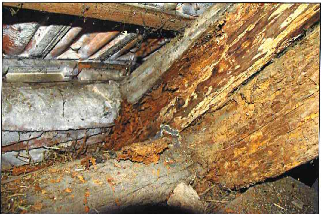
Abb. 26: Pilzschaden bei Sparren 33 (Zwischenbau, Bindergespärre, Traufe Westen).
