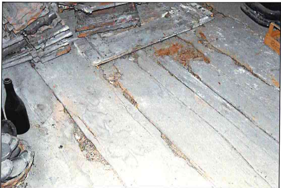
Abb. 32: Bodenbelag mit alten Pilz- und Insektenfraßschäden (1. Ebene, Decke über Wohnteil) .
