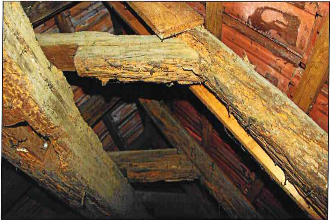
Abb. 41: Alte Hausbockfraßschäden im Dachraum des Zwischenbaus (2. Ebene).
