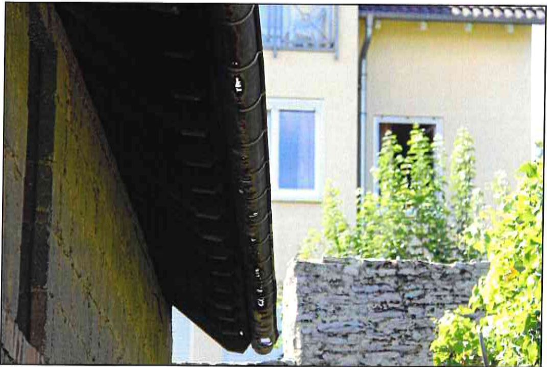
Abb. 54: Korrodierte Dachrinne an der östlichen Traufe des Zwischenbaus.
