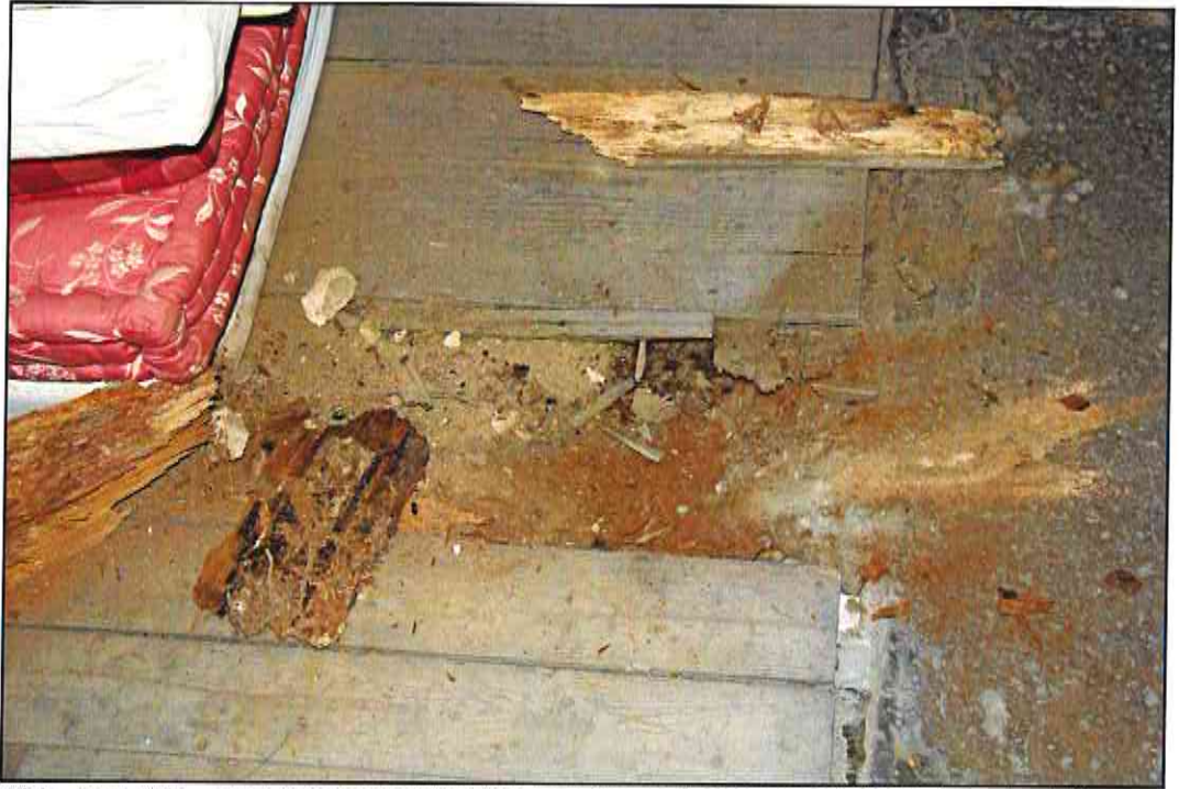
Abb. 07: Pilz- und Insektenschäden am Bodenbelag samt Unterkonstruktion.
