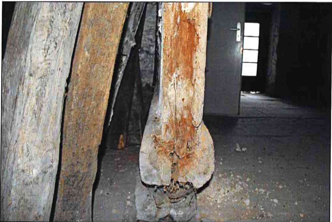
Abb. 09: Schadhafte Fachwerkhölzer bei Trennwand.
