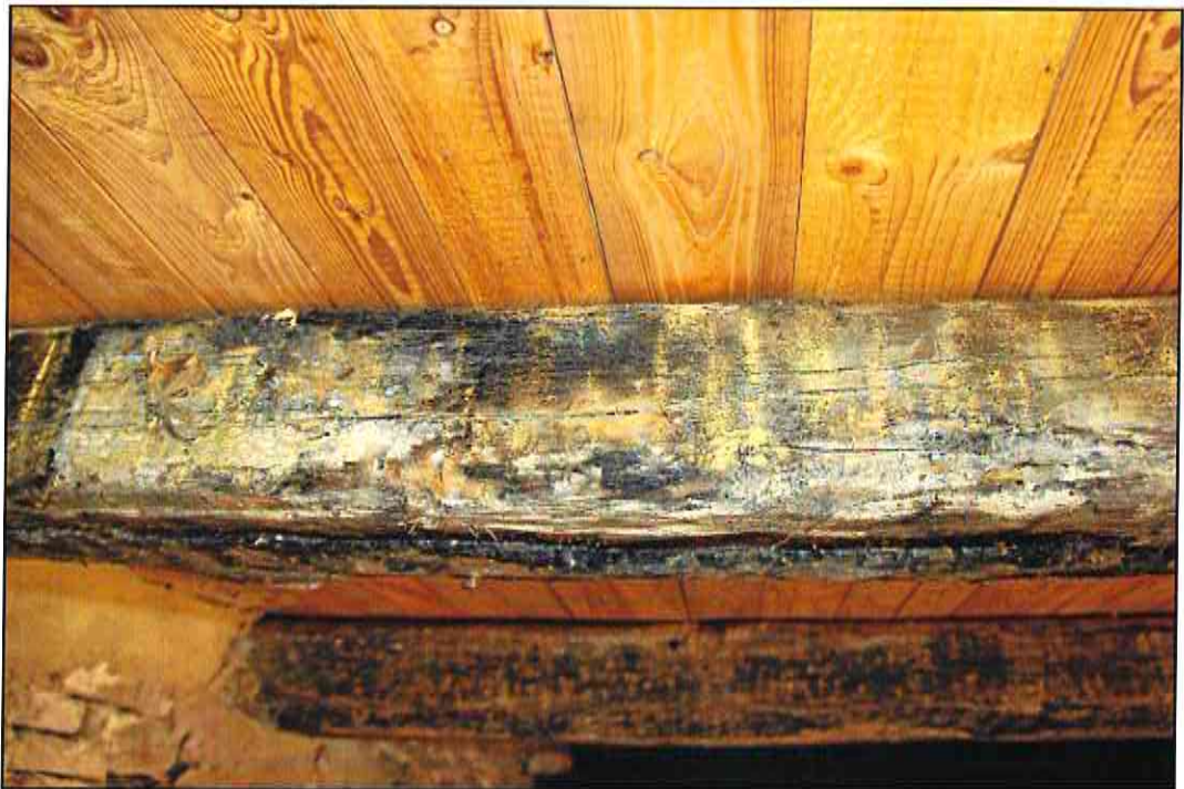
Abb. 12: Aktiver Befall des Gewöhnlichen Nagekäfers an Deckenbalken und Bodenbelag.
