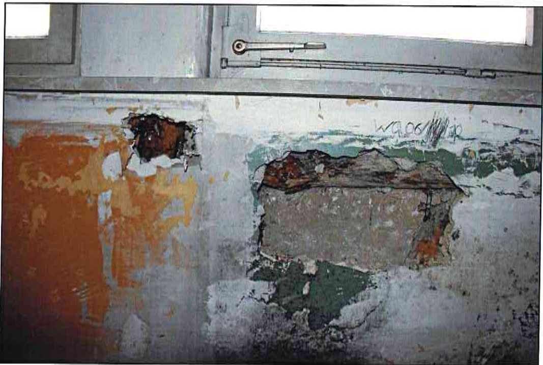
Abb. 17: Zumindest in Teilbereichen durch Pilzbefall abgängige Fachwerkhölzer an einer Fensterbrüstung.
