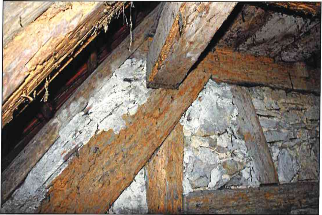
Abb. 37: Alte Hausbockfraßschäden an einer Stuhlstrebe (Zwischenbau, Binderge- spärre 13, Traufe Osten)
