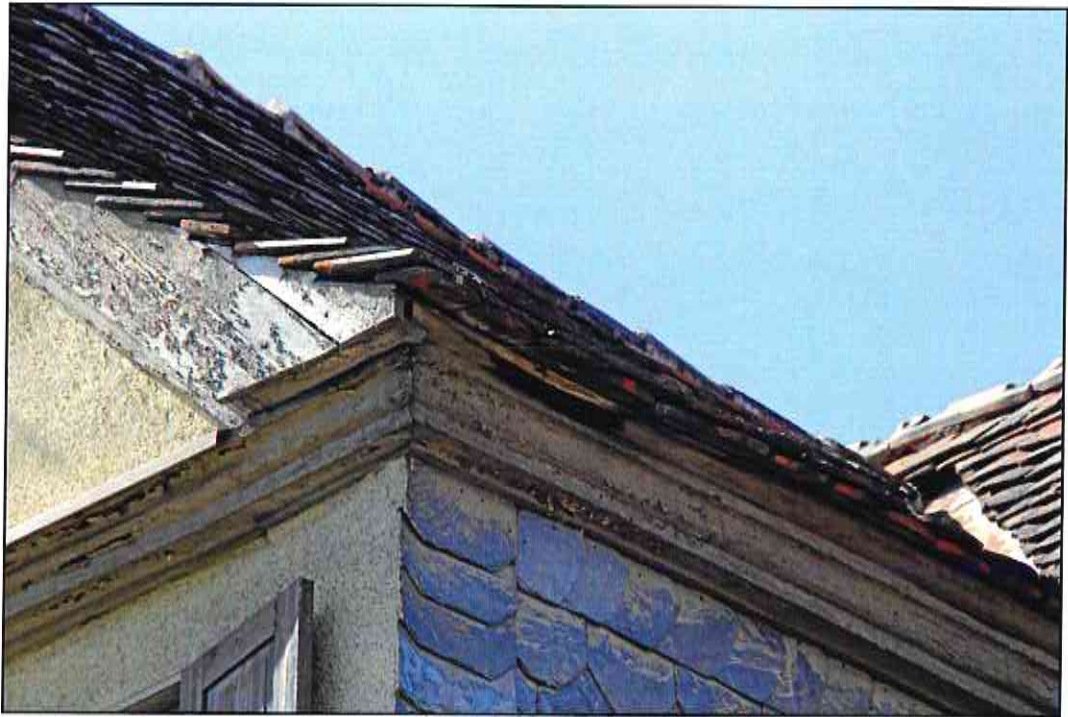
Abb. 54: Pilzschaden an Gesimsbalken des Querhausdaches.
