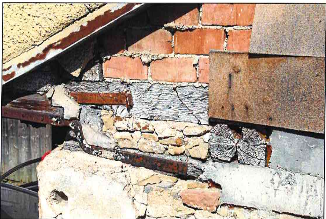
Abb. 03: Freiliegendes Mauerschwellenteilstück mit anschließendem Betongurt. Die einsehbaren Balkenköpfe und das Mauerlattenteilstück sowie die darüber befindlichen Fachwerkhölzer weisen mehr oder weniger umfangreiche Pilzschäden auf.
