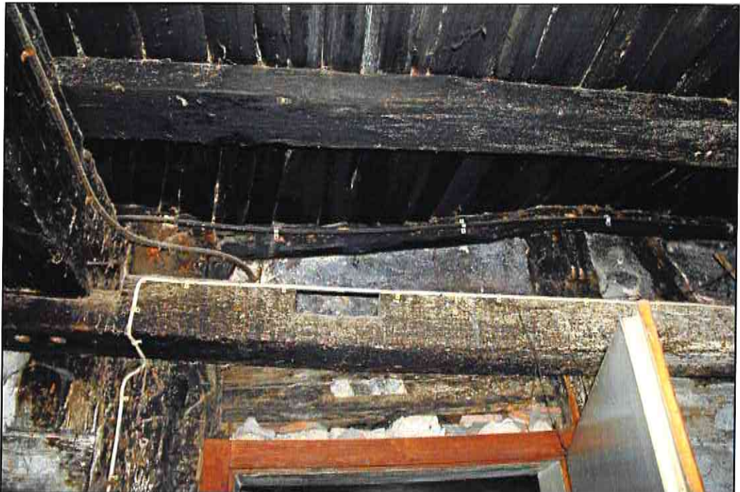
Abb. 11: Durch Pilzbefall in Teilbereichen abgängiger Deckenbalken (Wandrähm) infolge eines Wasserschadens. Angrenzende Holzbauteile wie Unterzüge, Ständer usw. weisen in Teilbereichen ebenfalls Schäden auf.
