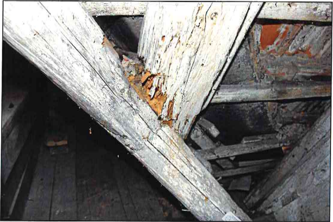
Abb. 39: Alte Hausbockfraßschäden an Kehlsparren und Schiftersparren (1. Ebene, Kehle Nordwesten).
