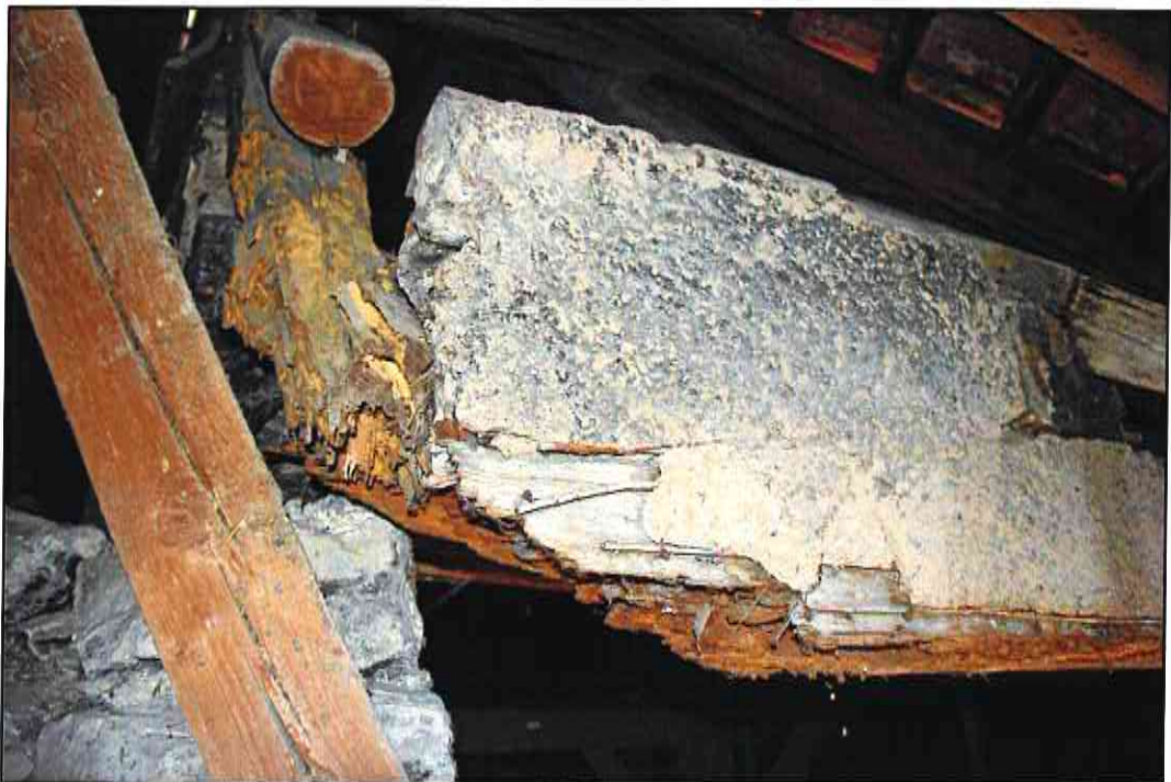
Abb. 24: Alter Pilz- und Insektenschaden im Auflagerbereich bei Fußpunkt 25 (Zwischenbau, Traufe Westen).
