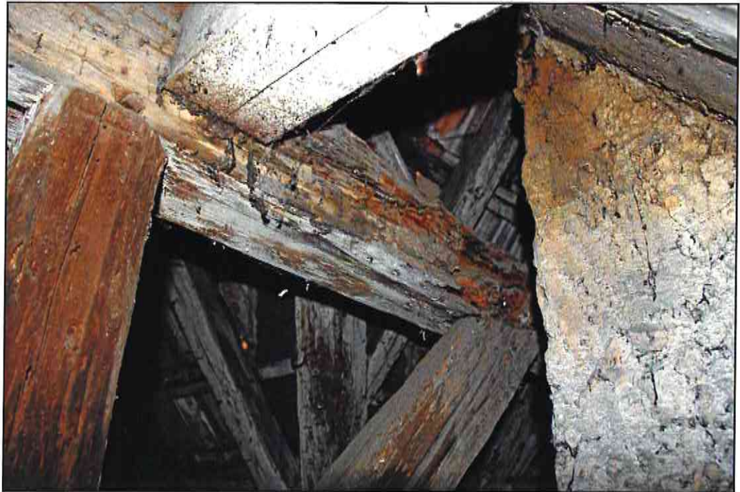
Abb. 31: Alter Pilz- und Insektenschaden an Unterzug bei den Sparren 3-6 (Schornstein, nördlicher Anbau).
