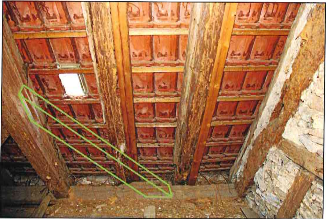
Abb. 49: Fehlendes Längsverbandsholz bei Gespärre Nr. 15 (Traufe Osten).
