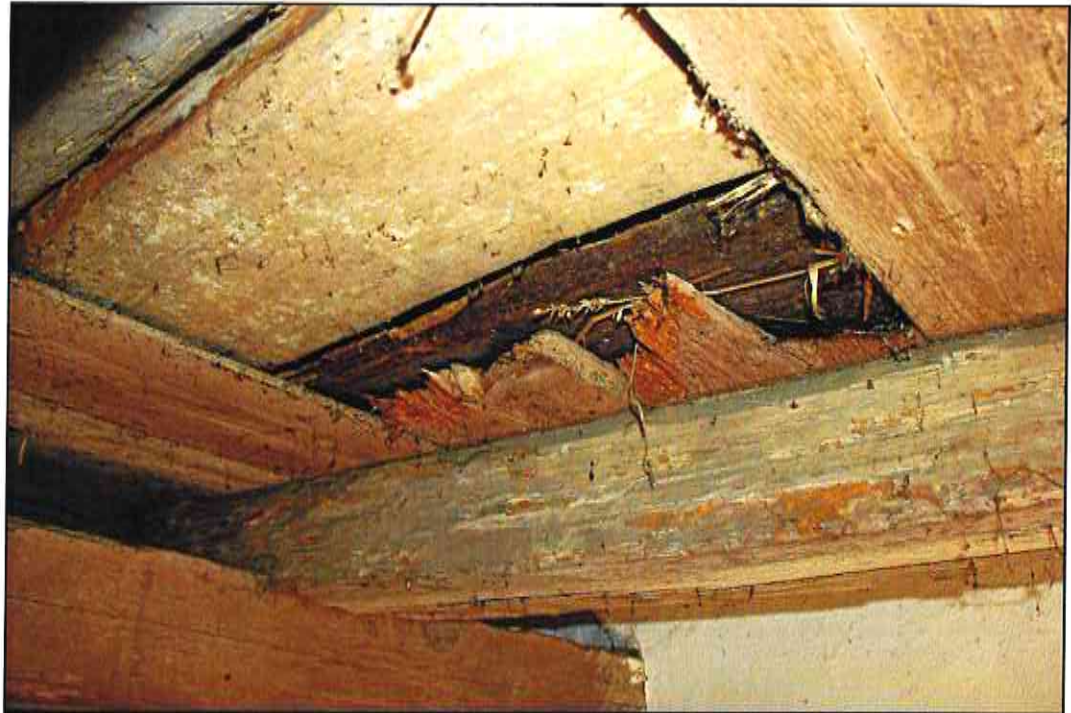
Abb. 21: Schadhafte Bodenbelagsbretter mit provisorischer Abdeckung.
