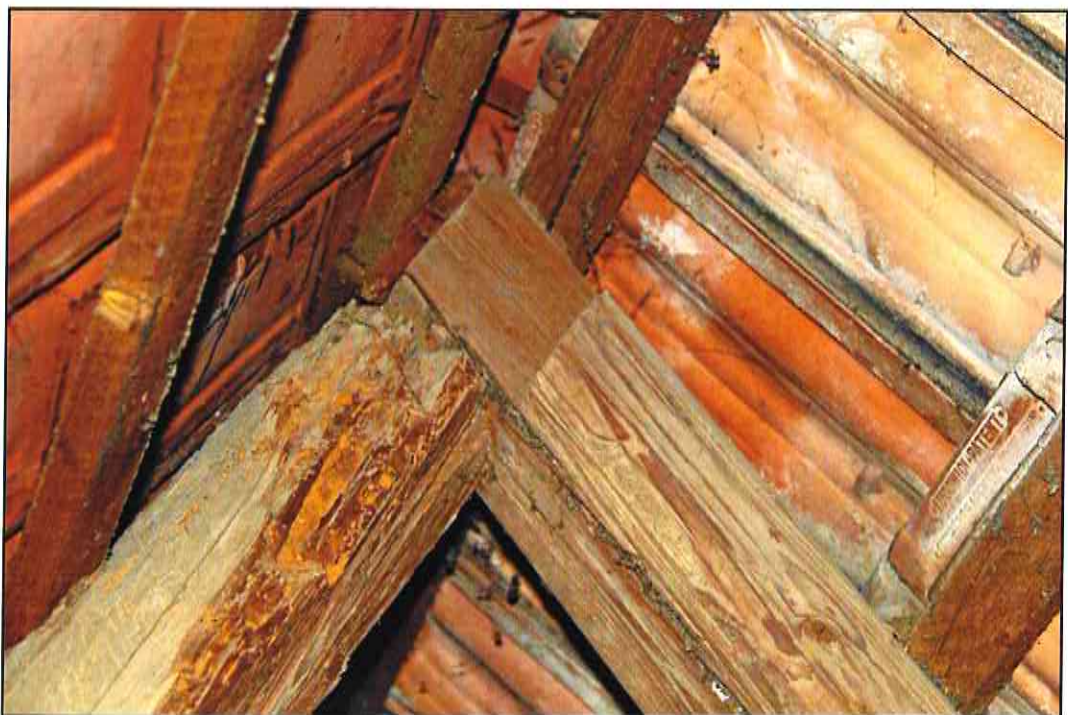
Abb. 46: Alte Hausbockfraßschäden im Dachraum des Zwischenbaus (2. Ebene).
