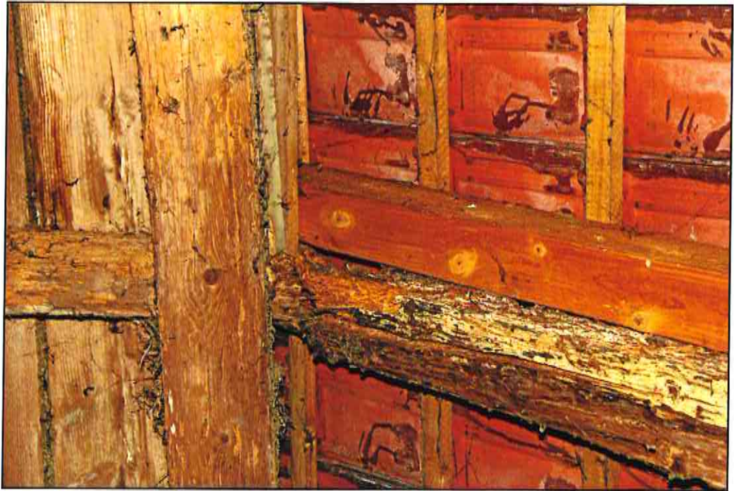
Abb. 47: Seitliche Kantholzverstärkung an Sparren mit Pilz- und Insektenschäden (Nr. 18, östliche Dachhälfte).
