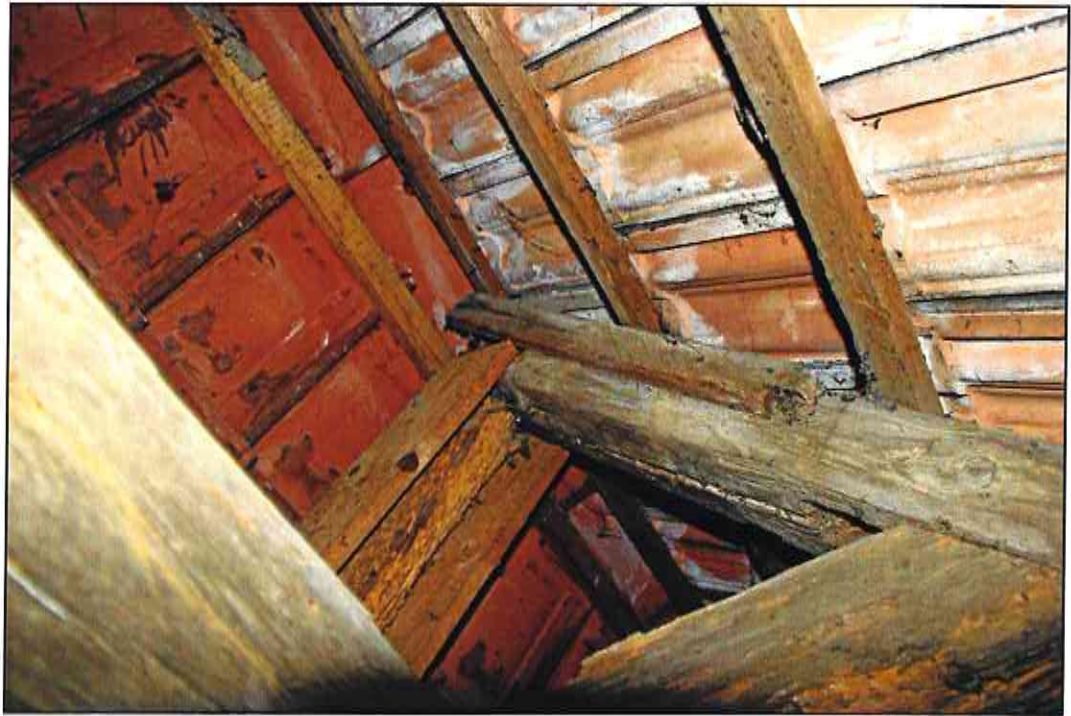
Abb. 45: Alte Hausbockfraßschäden im Dachraum des alten Ökonometeils (2. Ebene).
