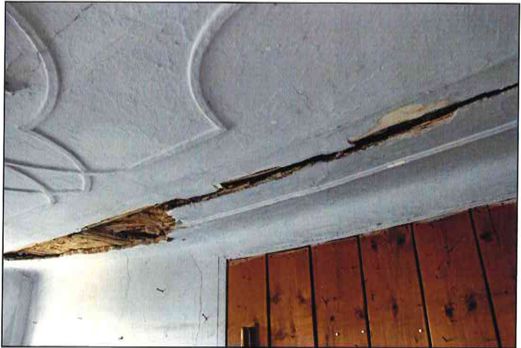
Abb. 22: Stuckablösungen an der Decke.
