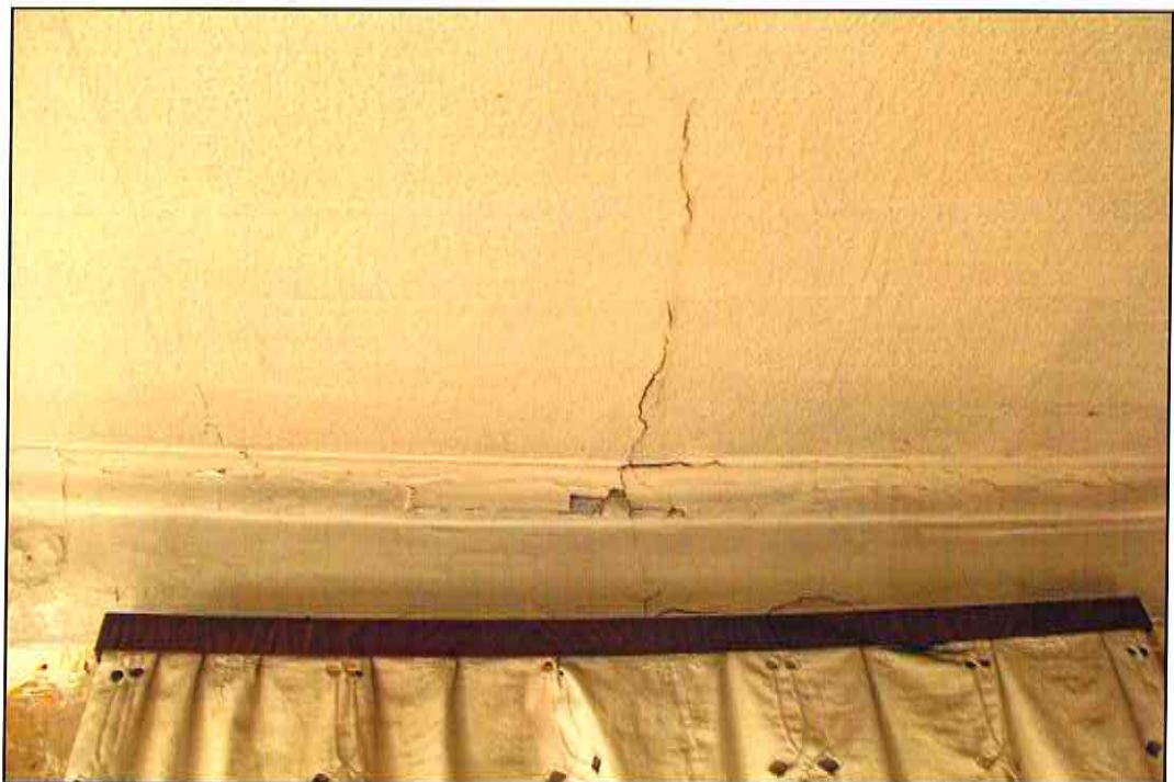
Abb. 15: Verformungen und Rissbildungen weisen auf Schäden im Auflagerbereich des Daches hin.
