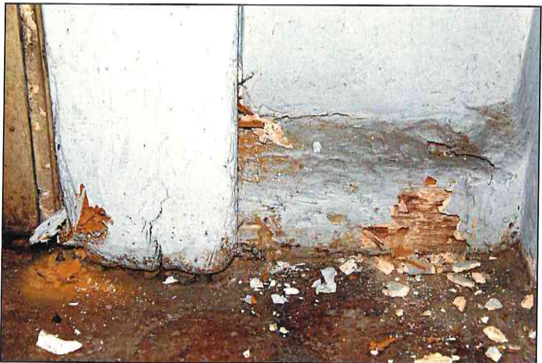
Abb. 08: Pilz- und Insektenschäden an Schwelle und Ständer der Flurwand.
