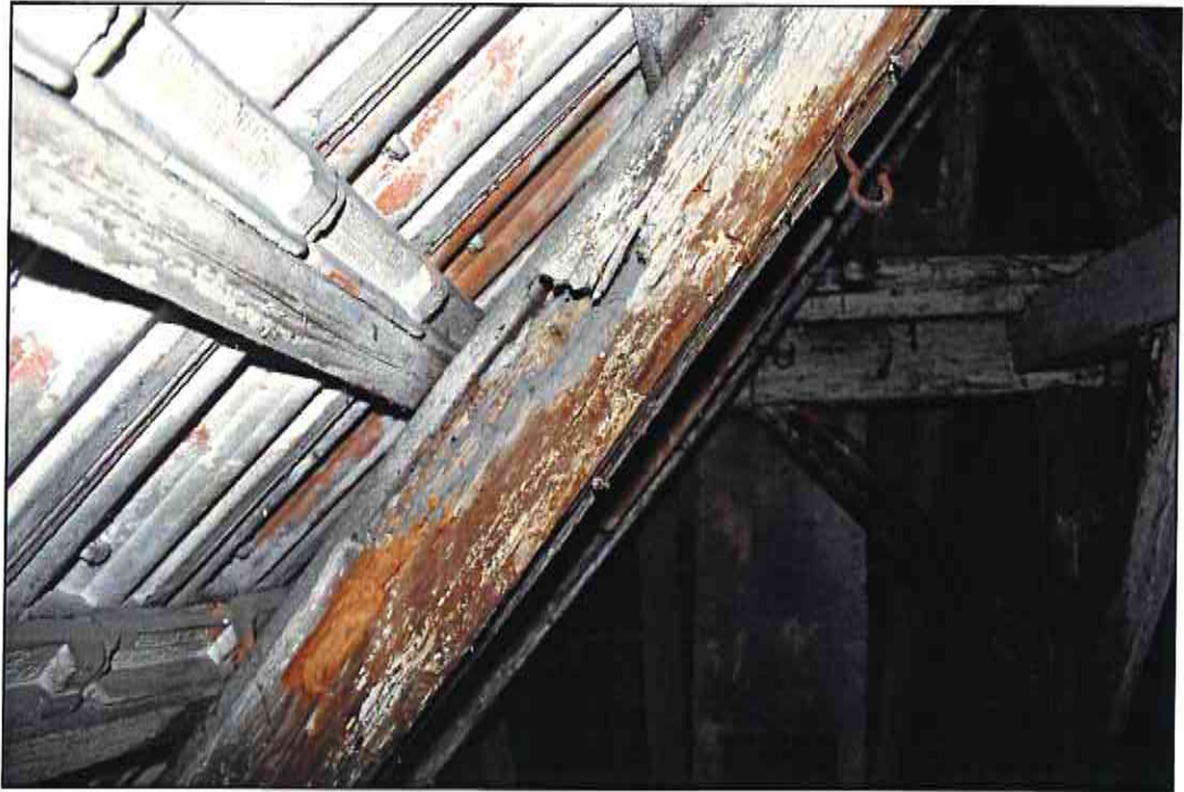
Abb. 33: Schadhafter Schiftersparren Nr. 40 (2. Ebene, nördliche Dachhälfte, Wohnteil).
