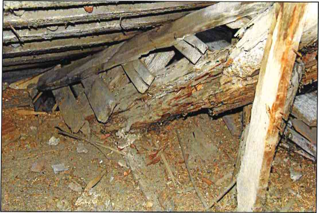
Abb. 29: Alte Pilz- und Insektenschäden beim Kehlsparren (2. Ebene, Zwerchdach, Nr. 70).
