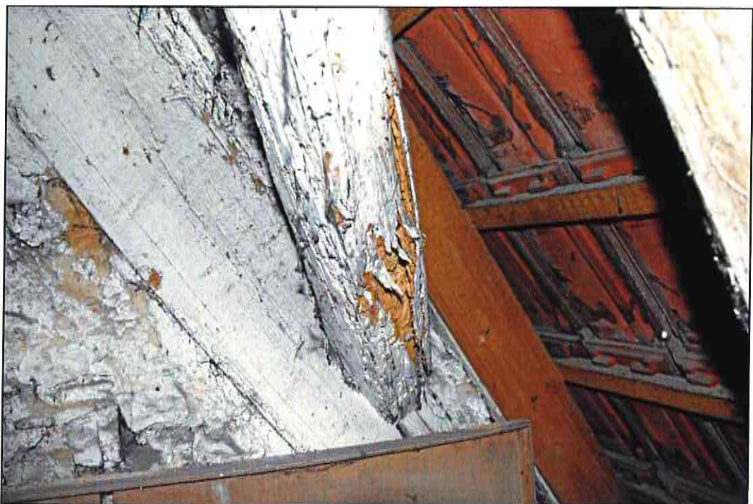
Abb. 38: Alte Hausbockfraßschäden an einem Längsverbandholz (Binderge- spärre 13, Traufe Osten).
