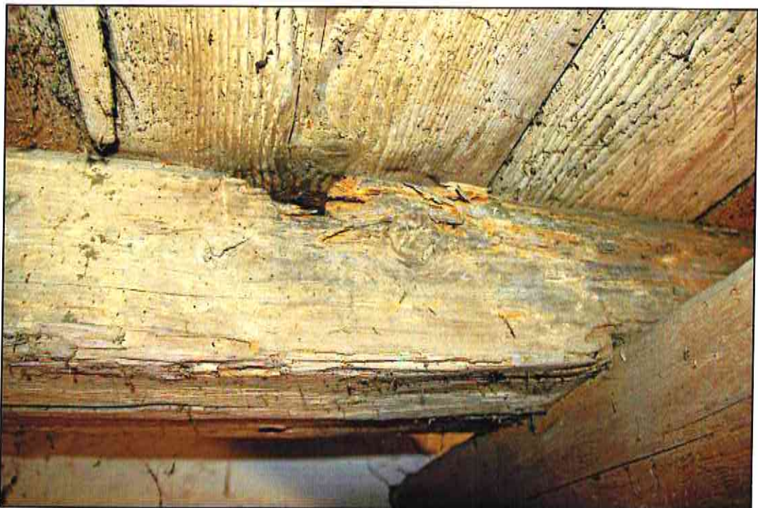
Abb. 20: Pilz- und Insektenschäden an einem Deckenbalken.
