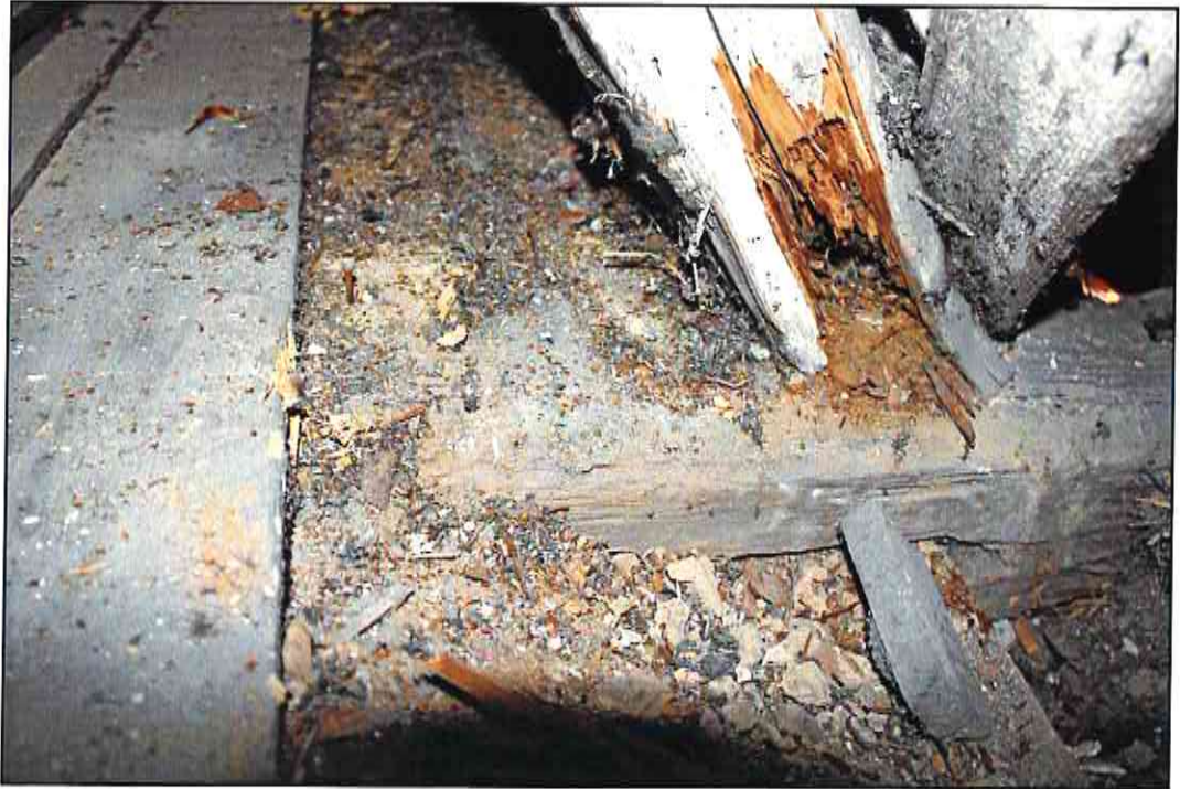
Abb. 27: Pilzschädigung (Innenfäule) bei Sparren 37 (Traufe Norden, Kehlan- schluss).
