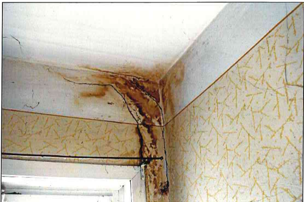
Abb. 19: Wasserflecken an Decke und Wand.
