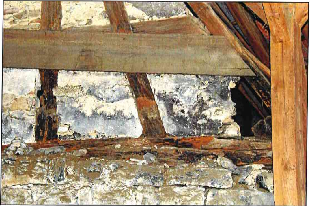
Abb. 35: Pilz- und Insektenschäden im Schwellbereich des nördlichen Fachwerkgiebels (Zwischenbau).
