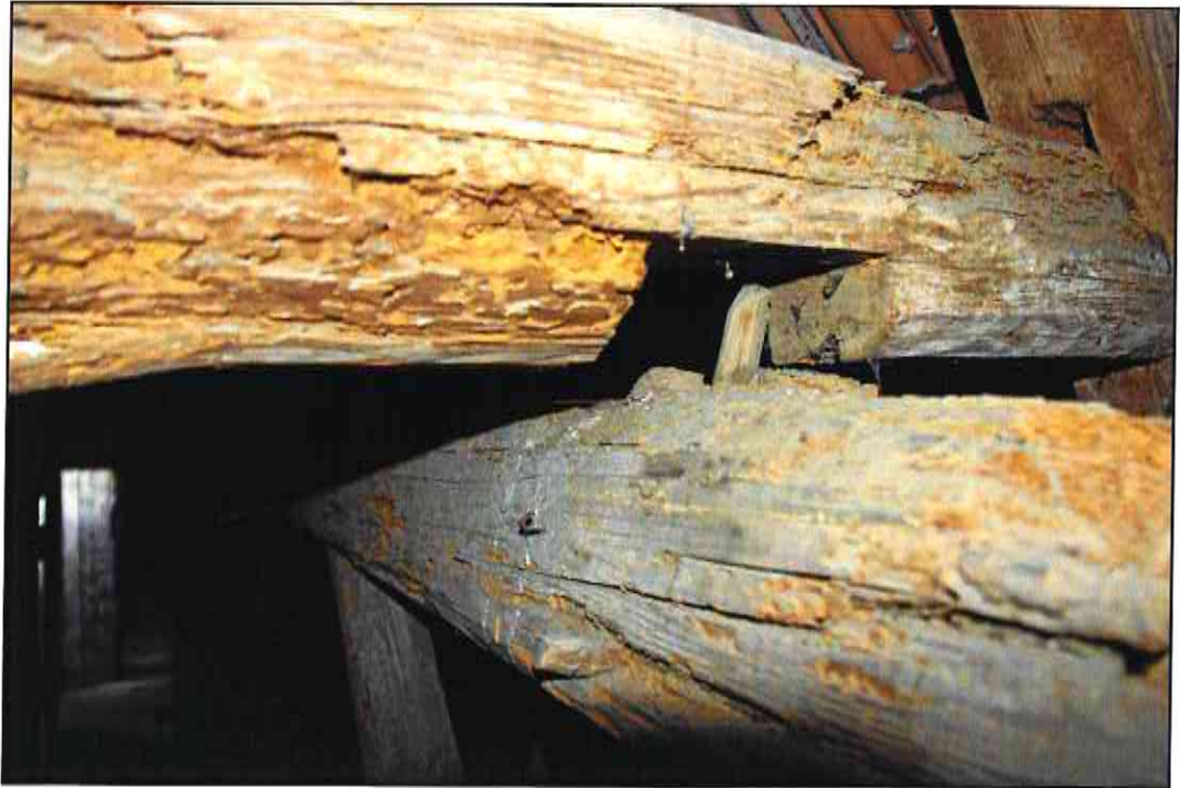
Abb. 43: Alte Hausbockfraßschäden im Dachraum des Zwischenbaus (2. Ebene).
