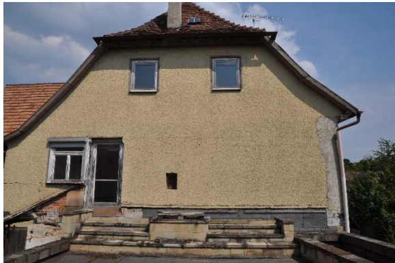
Außenfassade des Wohnhauses nach Westen, Frontalansicht mit Blickrichtung Osten, Foto: strebewerk. 2015 (Dateiname: Aussen_Lauffen_HH_20150813_2)
