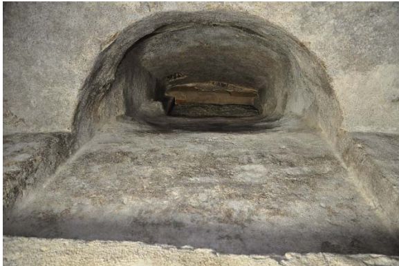
Raum -1.02a, Detailansicht des Lichtschachts an Wand a mit Blickrichtung Norden, Foto: strebewerk. 2015 (Dateiname: R102a_Lichtschacht_Lauffen_HH_20150813)
