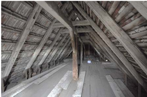
Raum 3.01b, Ansicht des Dachstuhls mit Blickrichtung Osten, Foto: strebewerk. 2015 (Dateiname: R301b_Lauffen_HH_20151005)
