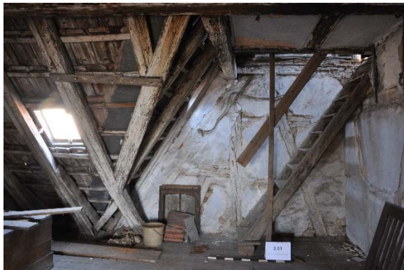
Raum 2.01a, Frontalansicht Wand a und Treppe mit Blickrichtung Norden, Foto: strebewerk. 2015 (Dateiname: R201a_Lauffen_HH_20150813)
