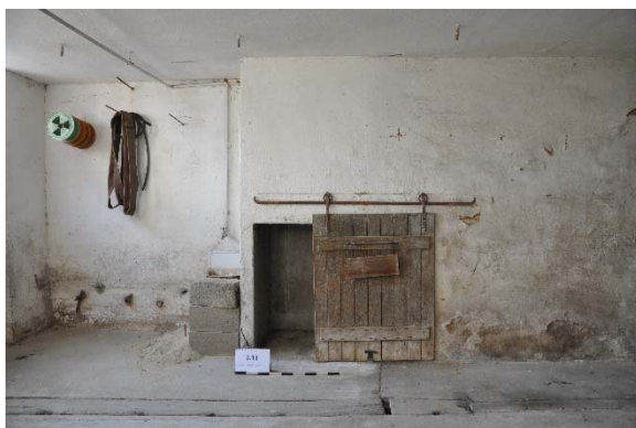
Raum 0.13d, Detailansicht der Schiebetür zum Schacht mit Blickrichtung Westen, Foto: strebewerk. 2015 (Dateiname: R013d_Tuer_Lauffen_HH_20150813)
