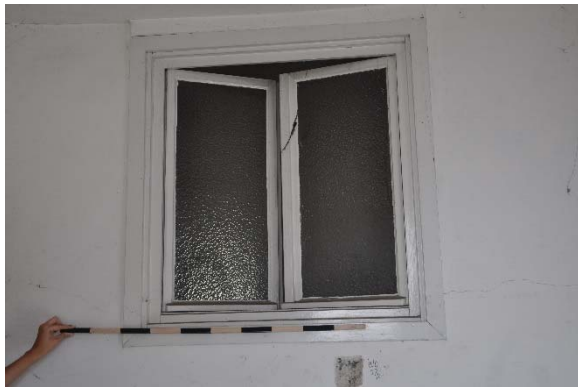
Raum 1.07d, Detailansicht des Fensters zu Raum 1.08 mit Blickrichtung Osten, Foto: strebewerk. 2015 (Dateiname: R107d_Fenster_Lauffen_HH_20150813)
