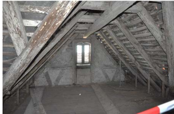
Raum 3.01c, Frontalansicht Wand c mit Blickrichtung Süden, Foto: strebewerk. 2015 (Dateiname: R301c_Lauffen_HH_20150813)
