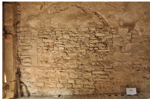
Raum 0.01d, Detailansicht des südlichen der zwei zusammengesetzten Arkadenbögen mit Blickrichtung Westen, Foto: strebewerk. 2015 (Dateiname: R001d_Arkade_Lauffen_HH_20150813)
