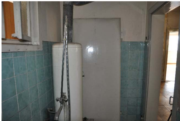
Raum 1.08c, Frontalansicht Wand c mit Blickrichtung Süden, Foto: strebewerk. 2015 (Dateiname: R108c_Lauffen_HH_20150813)
