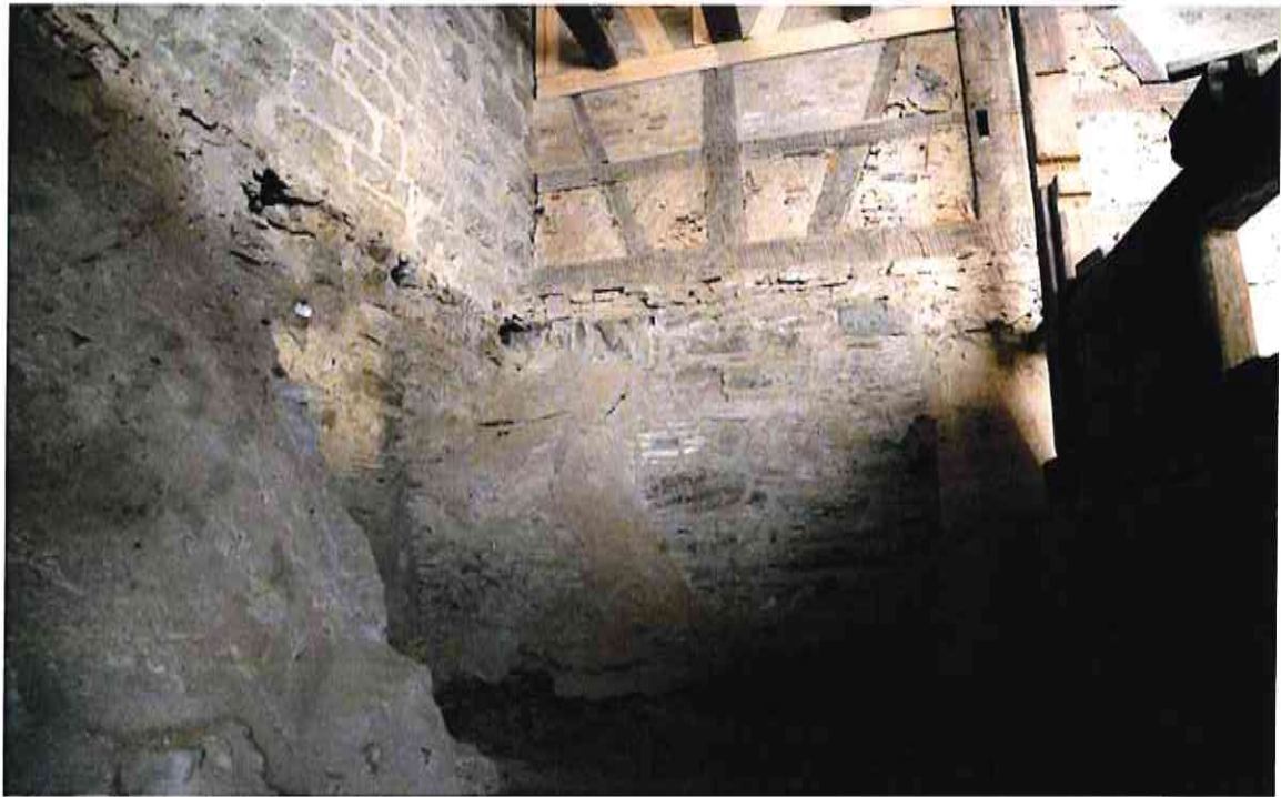
Nach dem Ausbau der Deckenbalken kommen weitere Schäden zutage
