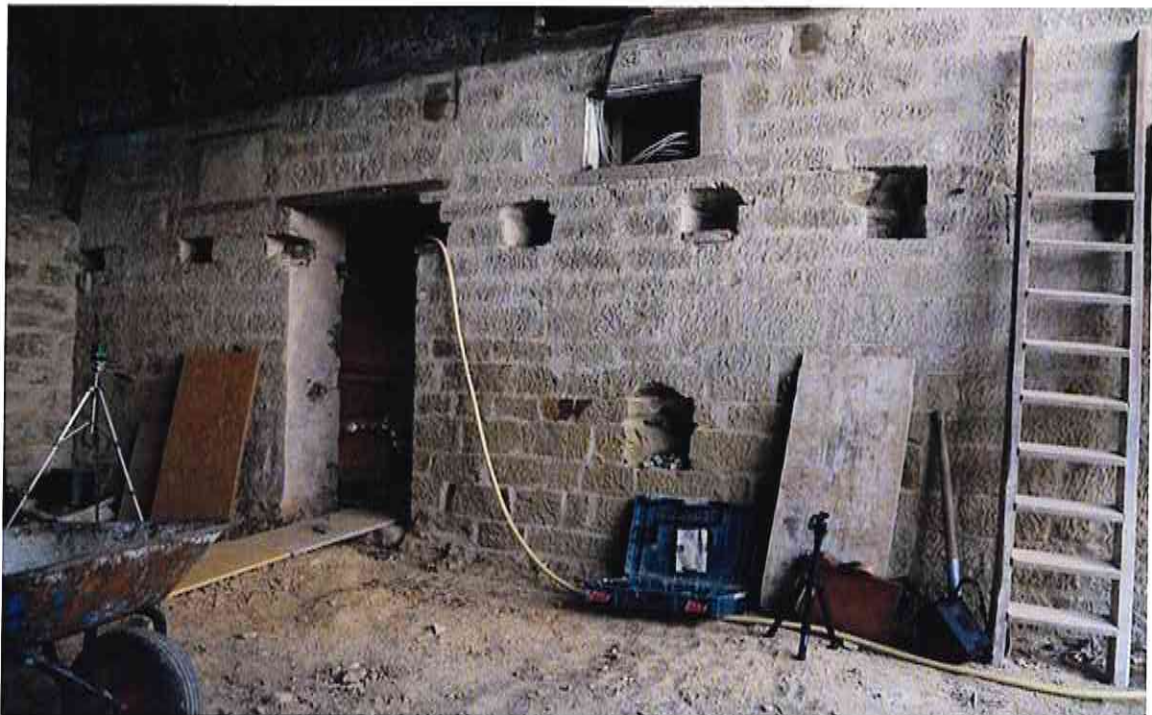
Ständige Umformulierung über den Umgang mit den Fehlstellen. Von Belassen bis jeden Mauerquader mit Vierung ergänzen.
