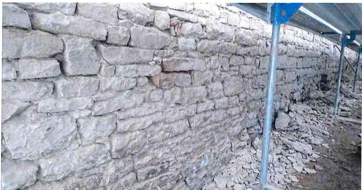
Abnehmen des Zementputz am Sockel Ost, Untergrund Muschelkalk.
