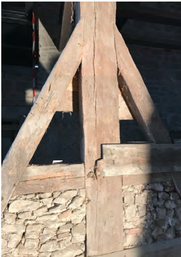
Foto 374: Raum 0.08, Wand a; aufliegende Verschmutzung.
