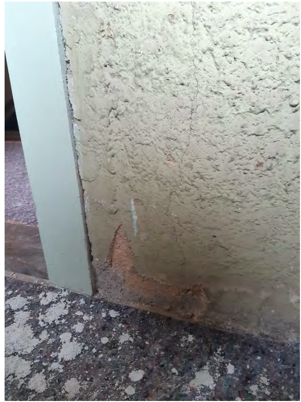
Foto 217: Raum 1.11, Wand c; Fehlstellen im Oberputz.
