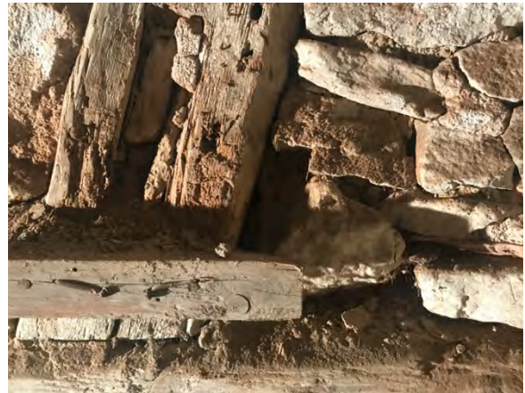
Foto 86: Detail aus Foto 85; aufliegende Verschmutzung.
