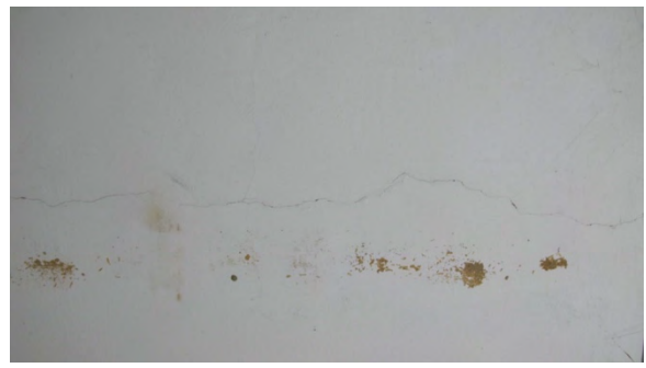
Foto 61: Raum 0.04, Wand b; Rissbildung.
