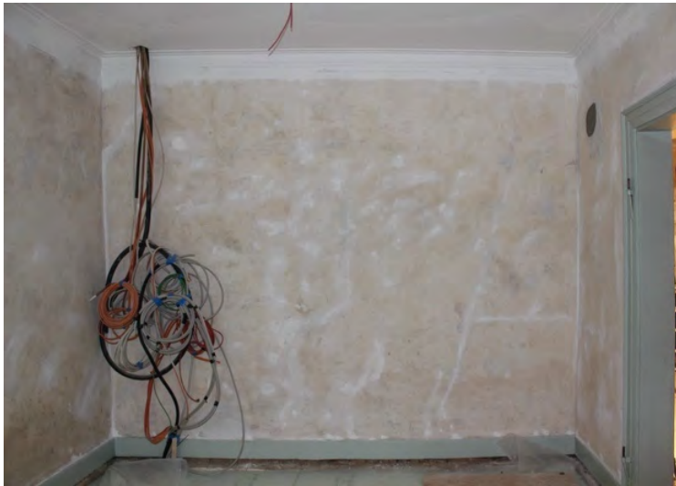
Foto 336: Raum 0.03, Wand a; ergänzte Fehlstellen und Risse.
