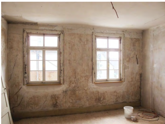
Foto 410: Raum 1.03, Wand c; geglättete Ergänzungen.
