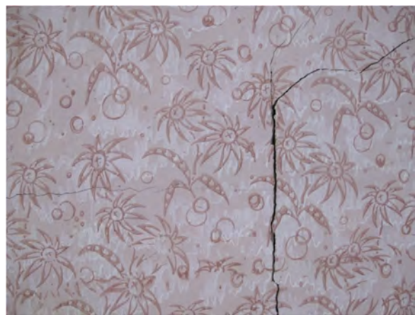
Foto 266: Raum 2.03, Wand a; Risse im Wandbereich.
