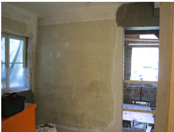
Foto 201: Raum 1.10, Wand a; Zustand vor Restaurierung.
