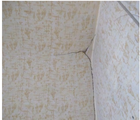
Foto 256: Raum 2.02, Wand a und b; Risse im Wandbereich.
