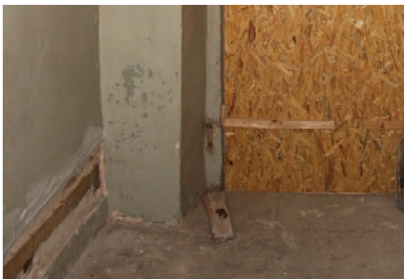
Foto 309: Raum 0.02, Wand d; Fehlstelle im Bereich des erneuerten Schwellenbalkens (links).
