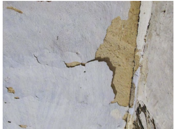
Foto 233: Raum 2.01, Decke; aufstehende Malschicht.
