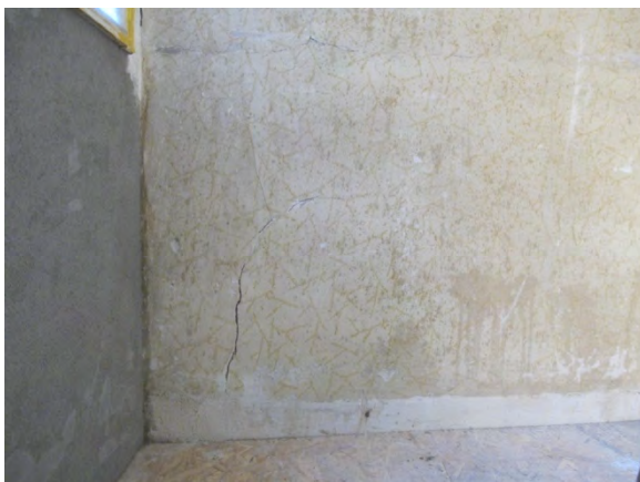
Foto 207: Raum 1.10, Wand a; Risse und Schimmel auf der Wandfläche.
