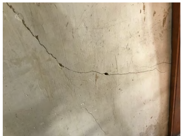
Foto 241: Raum 2.01, Wand c; Risse im Wandbereich.
