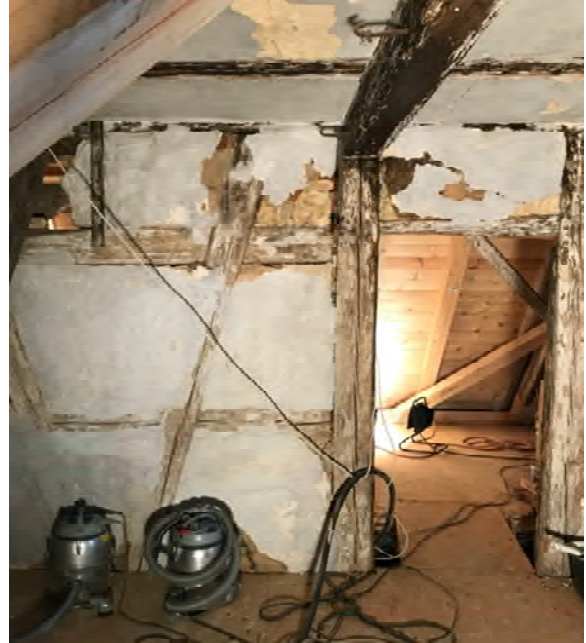
Foto 229: Raum 2.01, Wand b; Zustand vor Restaurierung.
