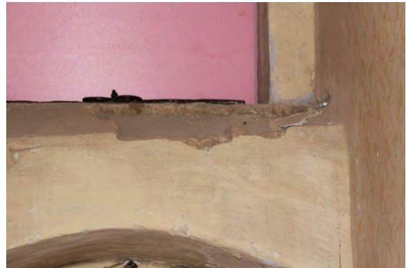
Foto 35: Raum 0.02, Wand d; Bereich ohne Walzenmuster mit Fehlstelle im Verputz.
