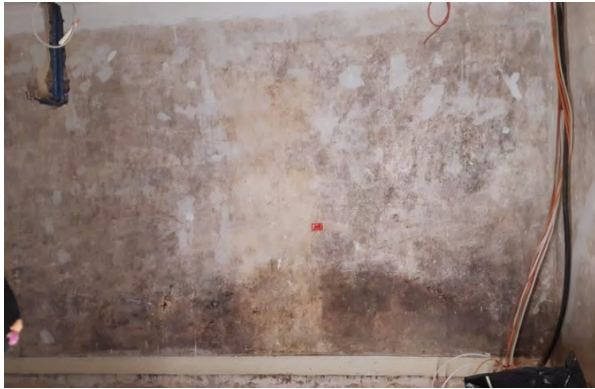
Foto 334: Raum 0.03, Wand d; Schimmelbefall.
