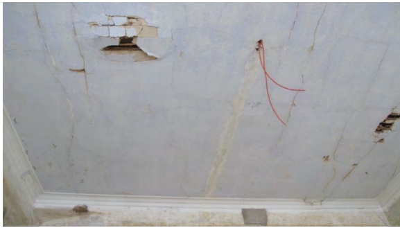
Foto 426: Raum 1.05, Decke; Vorzustand (Putzfehlstellen).
