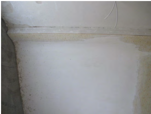
Foto 247: Raum 2.02, Wand a; Zustand vor Restaurierung.
