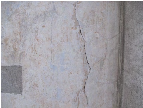
Foto 134: Raum 1.03, Wand c; Risse im Verputz.
