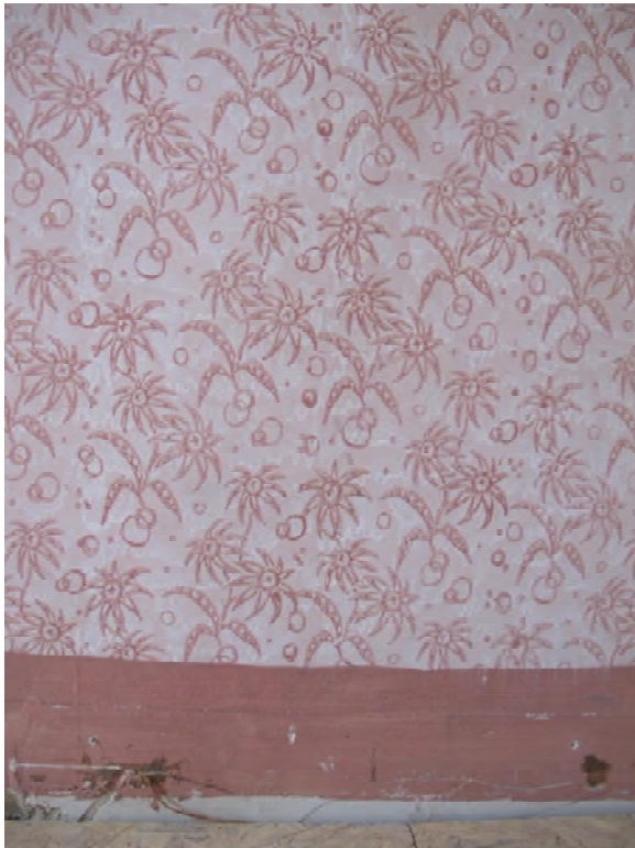
Foto 267: Raum 2.03, Wand a; Fehlstellen in der Fassung und Nagellöcher in der Sockelzone.
