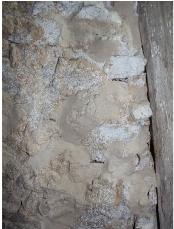
Foto 535: Raum 2.05, Wand d; ergänzte Fehlstellen.
