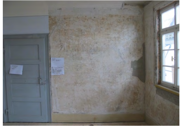
Foto 131: Raum 1.03, Wand b; Zustand vor Restaurierung.
