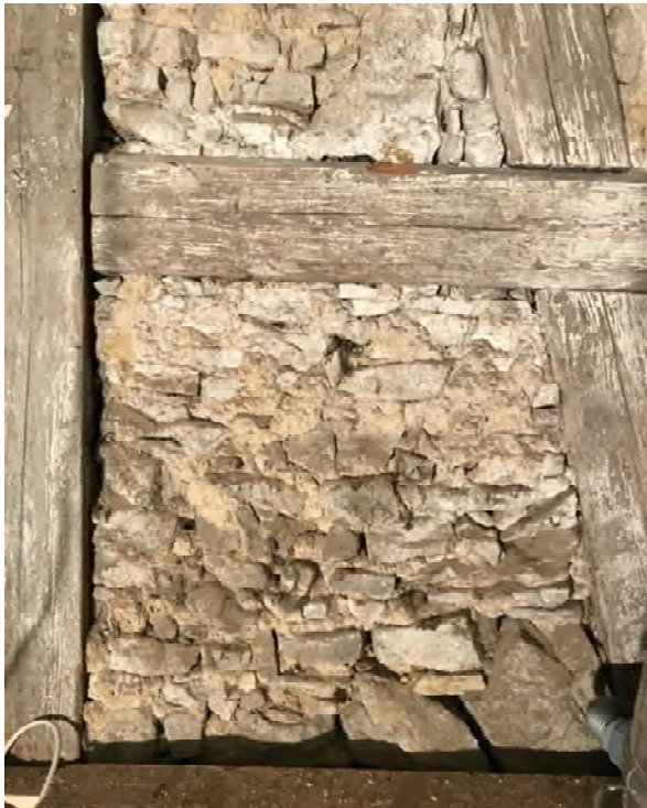
Foto 285: Raum 2.05, Wand d; teilweise entfestigtes Mauerwerk und Putz mit lose aufliegender Verschmutzung.
