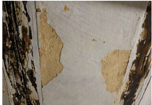
Foto 237: Raum 2.01, Decke; Fehlstellen in der Fassung.
