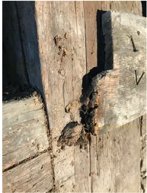
Foto 96: Raum 0.08, Wand d; Verschmutzungen.
