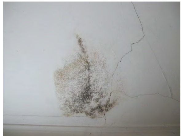
Foto 135: Raum 1.03, Decke; Schimmelbefall.
