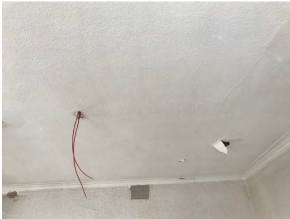
Foto 158: Raum 1.05, Decke; Zustand vor Restaurierung.
