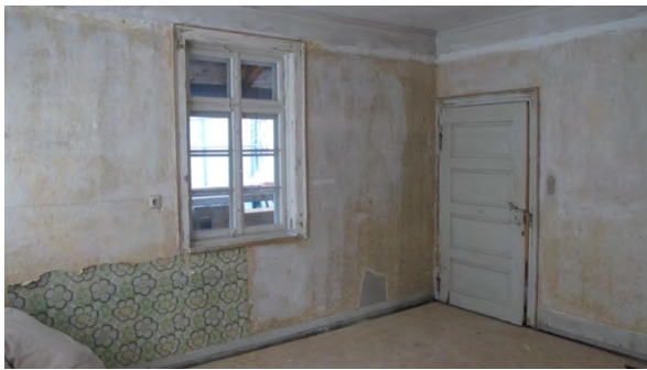
Foto 397: Raum 1.02, Wand a; ergänzte Fehlstellen in Wand und Stuck.
