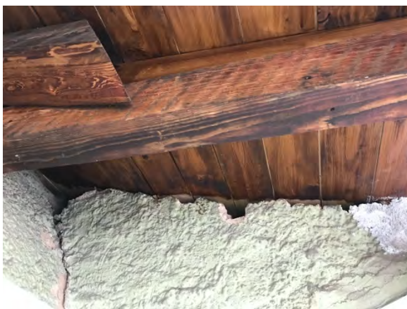
Foto 214: Raum 1.11, Wand d; Fehlstellen im Putz.
