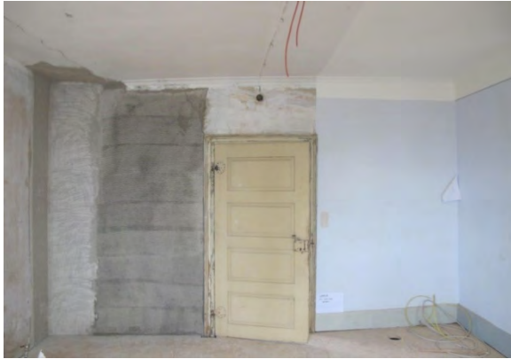
Foto 130: Raum 1.03, Wand a; Zustand vor Restaurierung.
