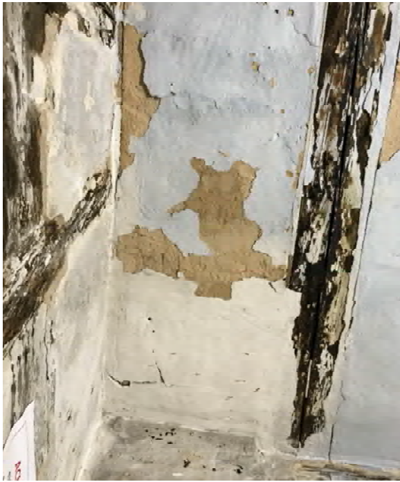
Foto 492: Raum 2.01, Decke; aufstehende Farbschollen.
