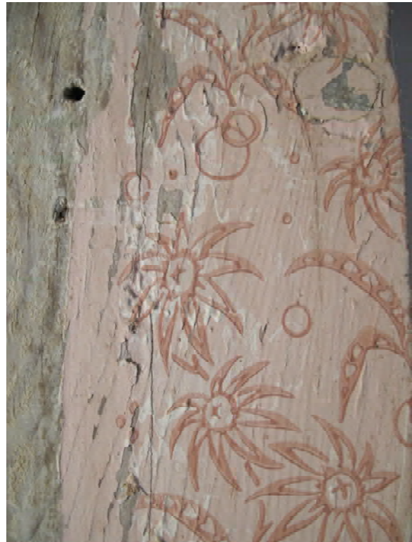
Foto 268: Raum 2.03, Wand b; Fassungsschäden.
