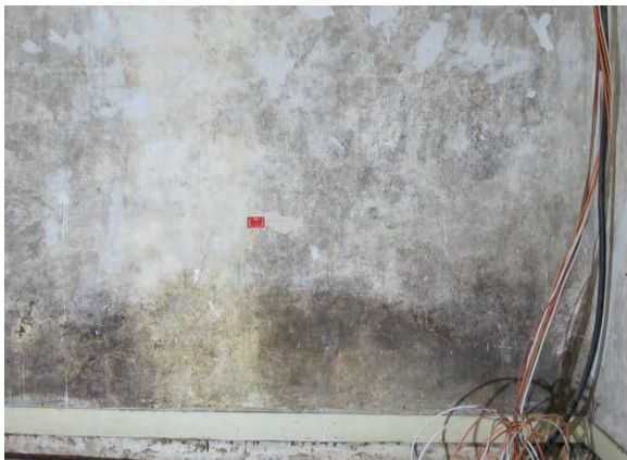
Foto 45: Raum 0.03, Wand d; Detail Schimmelbefall.
