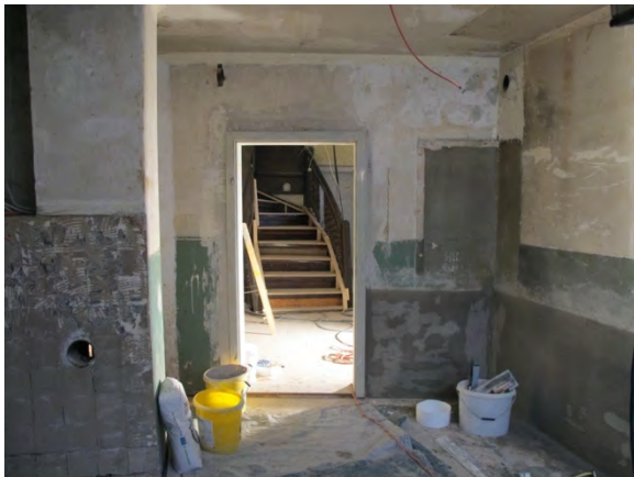
Foto 432: Raum 1.06, Wand a, c und d; großflächige Verputzungen und unverputzter Fliesenspiegel.
