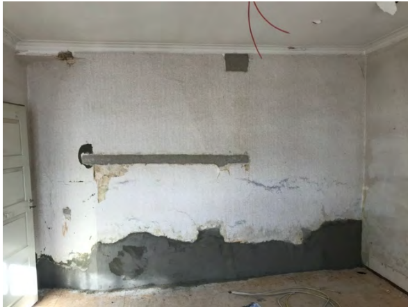
Foto 154: Raum 1.05, Wand a; Zustand vor Restaurierung.
