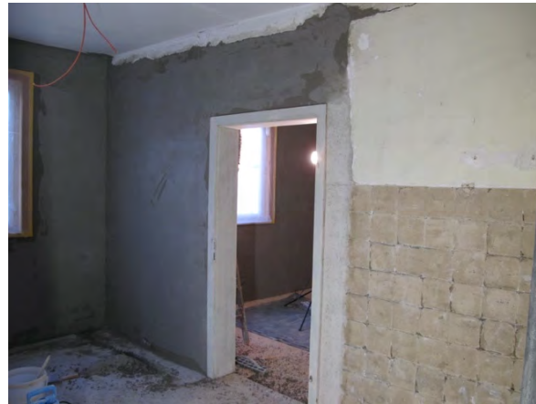
Foto 179: Raum 1.07 und 1.08, Wand d; Zustand vor Restaurierung.
