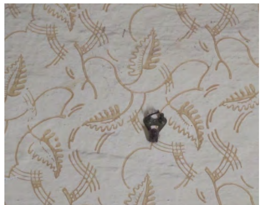
Foto 25: Raum 0.02, Wand b; Bilderhaken.
