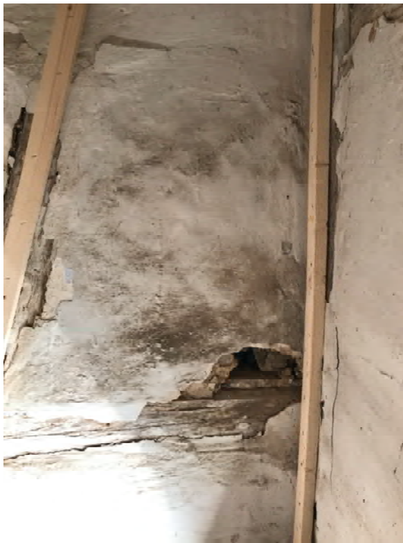
Foto 194: Raum 1.09; Wand b; Fehlstellen in Mauerwerk, Putzmörtel und Fassung.
