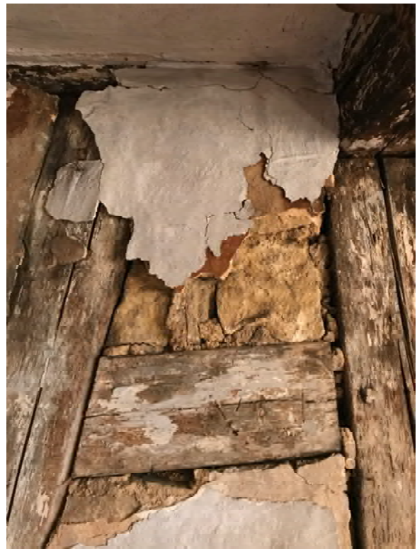
Foto 235: Raum 2.01, Wand b; loses Mauerwerk, hohl liegender Putz und Fassungschichten.
