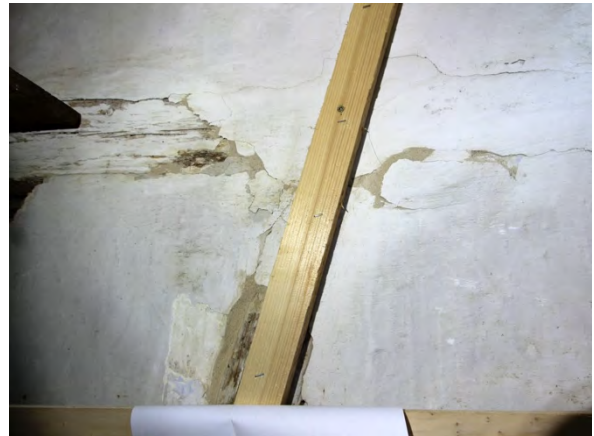
Foto 452: Raum 1.09, Wand a; niedergelegte Farbschollen.
