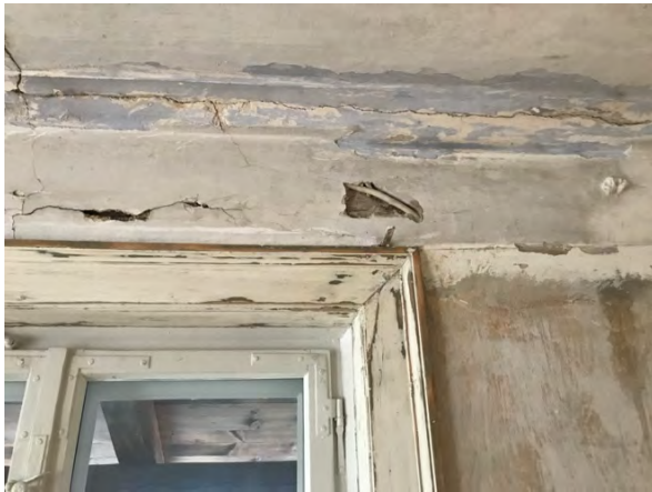
Foto 395: Raum 1.02, Wand a; schadhaftes Stuckprofil.
