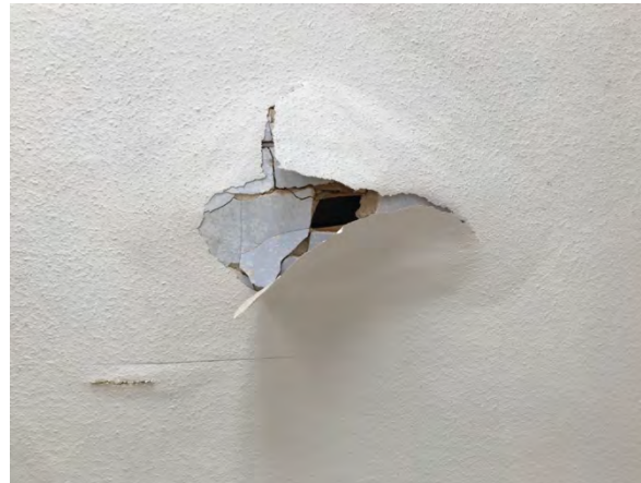
Foto 159: Raum 1.05, Decke; durchgetretener Bereich.
