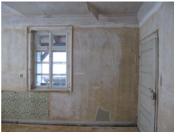
Foto 119: Raum 1.02, Wand a; Zustand vor Restaurierung.
