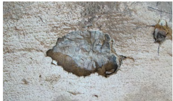
Foto 15: Durchfahrt (Raum 0.01, Wand d); Fehlstelle im Putz mit hohl liegendem Bereich.
