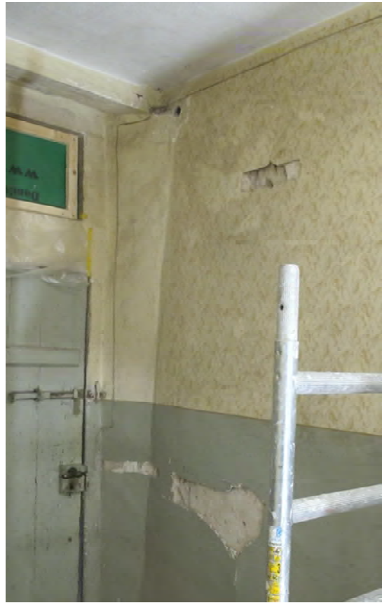
Foto 27: Raum 0.02, Wand d; Sondagen/ Fehlstellen im Verputz.
