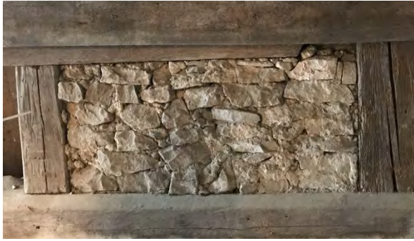
Foto 376: Raum 0.08, Wand a; entfestigte Ausfachung.
