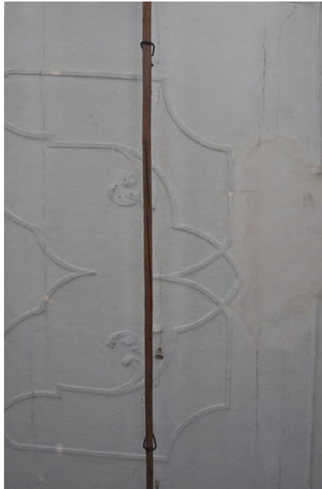
Foto 275: Raum 2.04, Decke; Zustand vor Baumaßnahme.
