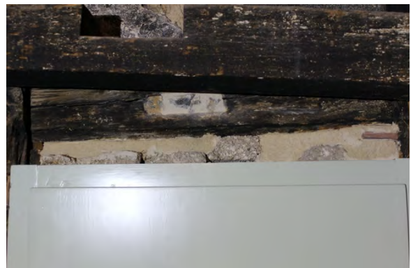
Foto 363: Wie Foto 362; Endzustand Bereich über Tür.
