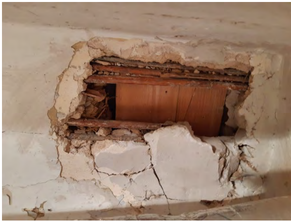
Foto 58: Raum 0.04, Decke; Fehlstelle im Deckenverputz.
