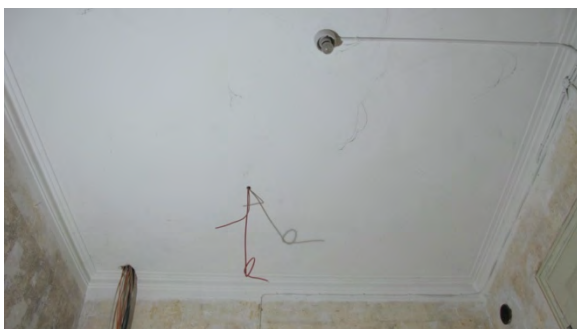
Foto 47: Raum 0.03, Decke; Zustand vor Restaurierung.
