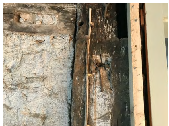
Foto 84: Raum 0.06, Wand c; alte Verdrahtung und Nägel.
