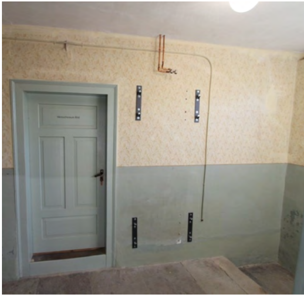
Foto 327: Raum 0.02, Wand b rechts; Endzustand.
