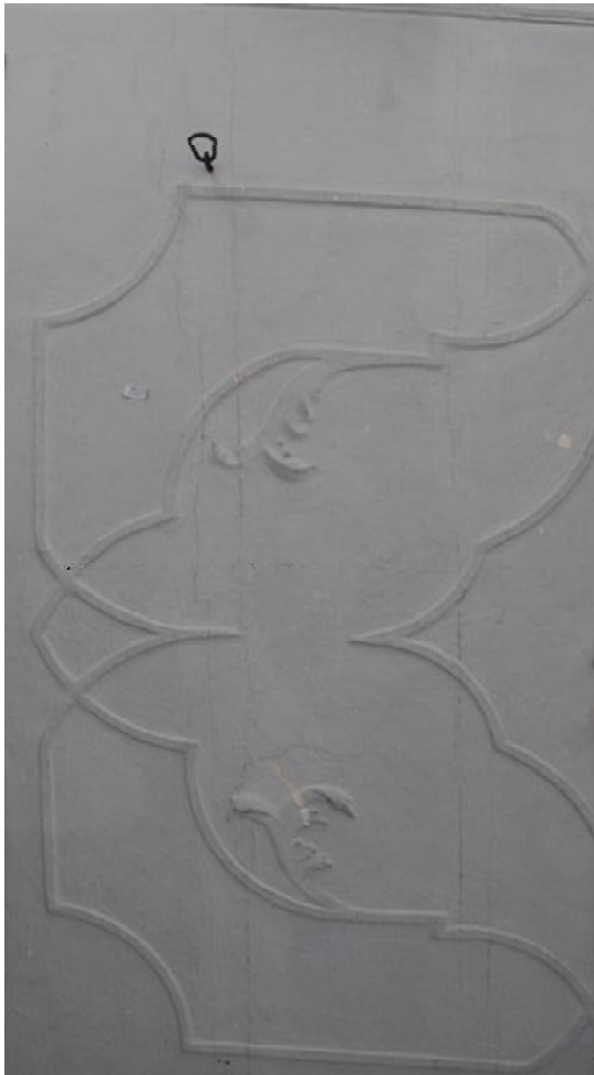
Foto 274: Raum 2.04, Decke; Zustand vor Baumaßnahme.
