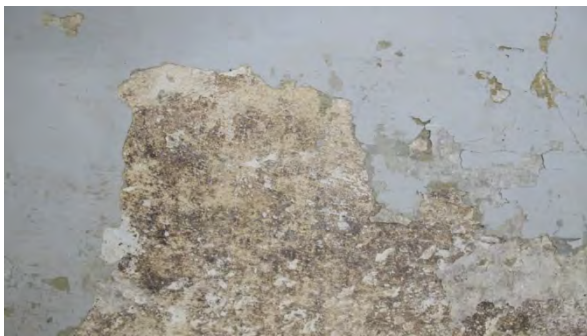
Foto 60: Raum 0.04, Wand b; Schimmel unter Fassungen.
