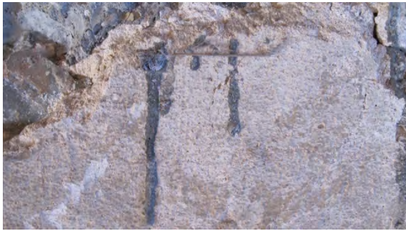
Foto 18: Durchfahrt (Raum 0.01, Wand d); Betonläufer auf historischem Putz.
