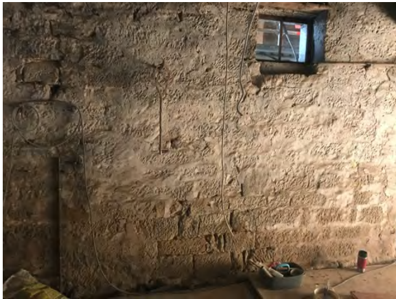
Foto 79: Raum 0.06, Wand a; Zustand vor Restaurierung.
