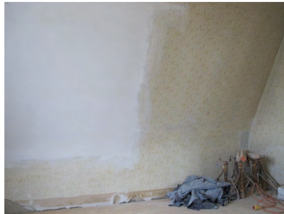
Foto 248: Raum 2.02, Wand a; Zustand vor Restaurierung.
