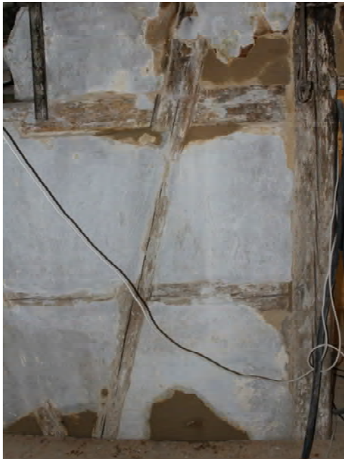
Foto 488: Raum 2.01, Wand b; Mörtelergänzungen.
