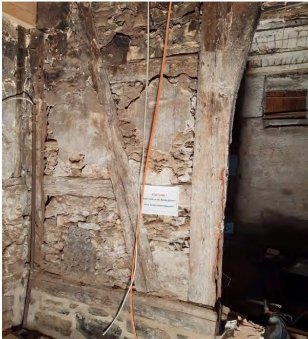
Foto 68: Raum 0.05, Wand a; Zustand vor Restaurierung.
