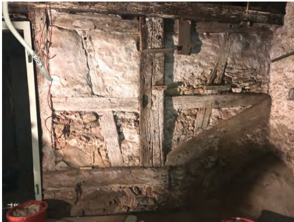
Foto 85: Raum 0.06, Wand d; Verschmutzung auf Wandoberfläche.
