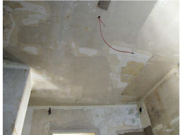
Foto 168: Raum 1.06, Decke; Zustand vor Restaurierung.
