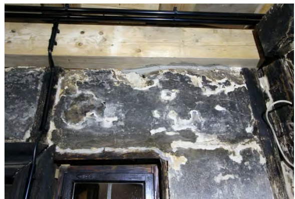
Foto 353: Raum 0.05, Wand d; Randsicherungen.
