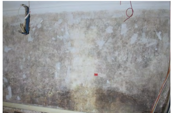
Foto 44: Raum 0.03, Wand d; nach Entfernung der Tapete mit großflächigem Schimmelbefall.
