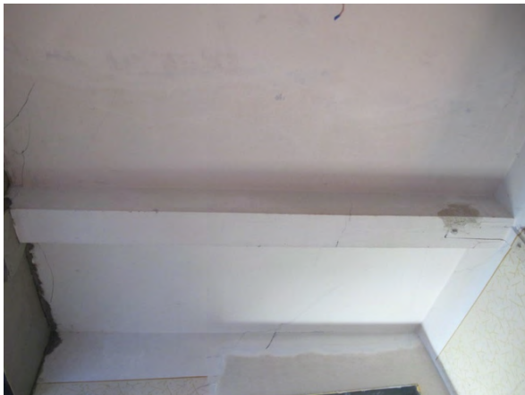
Foto 205: Raum 1.10, Decke; Zustand vor Restaurierung.
