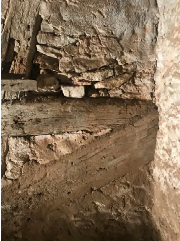
Foto 360: Raum 0.06, Wand c; Vorzustand - verschmutzte Oberfläche sowie entfestigtes Gefach.
