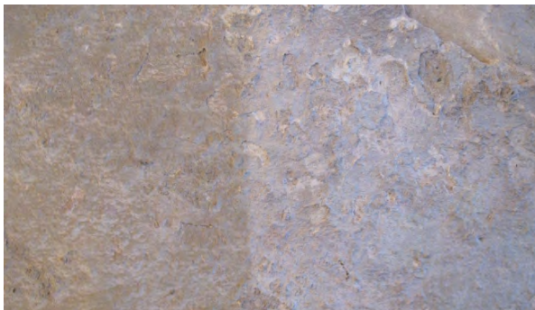
Foto 14: Durchfahrt (Raum 0.01, Wand d); Teilweise versinterte Oberfläche mit stellenweise strukturell entfestigten Bereichen.
