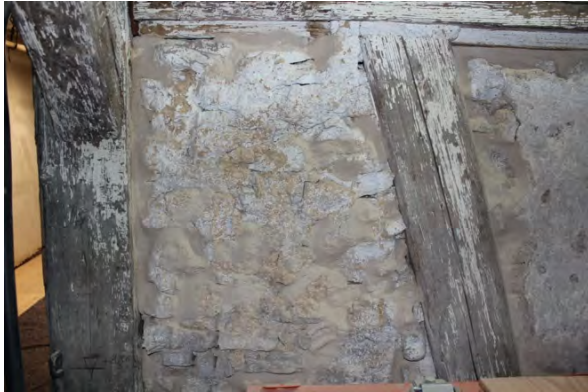
Foto 532: Raum 2.05, Wand d; Ergänzte Fehlstellen.
