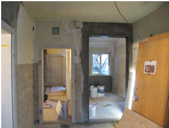
Foto 180: Raum 1.08, Wand a; Zustand vor Restaurierung.
