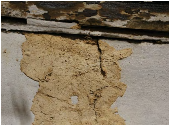
Foto 238: Raum 2.01, Decke; Risse im Lehmputz.
