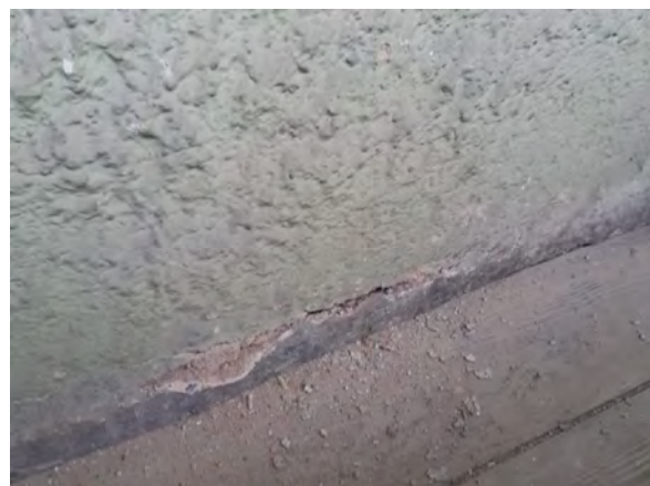
Foto 215: Raum 1.11, Wand c; Risse im Putz.
