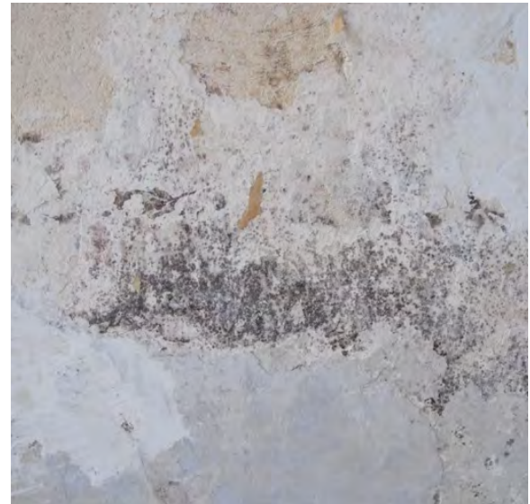
Foto 146: Raum 1.04, Wand d; Schimmelbefall unter Spachtelung.
