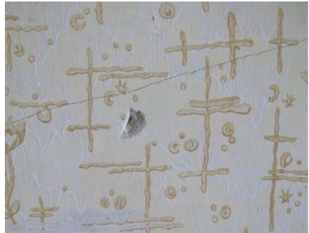
Foto 258: Raum 2.02, Wand c; Riss und Fehlstelle im Putz.
