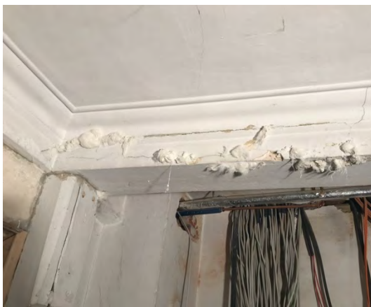
Foto 345: Raum 0.04, Decke; Fehlstelle.
