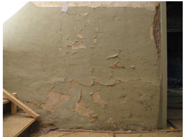
Foto 37: Raum 0.02, Wand a; Aufstehende Malschicht in der Sockelzone.
