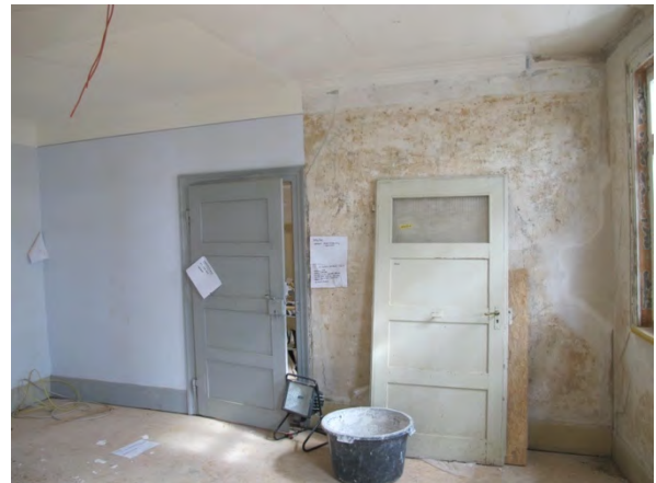
Foto 407: Raum 1.03, Wand b; Putzergänzungen an Decke und Wand.
