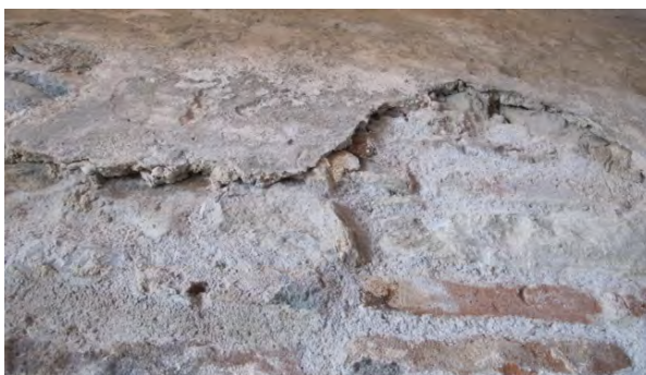
Foto 16: Durchfahrt (Raum 0.01, Wand d); lose Putzkante.
