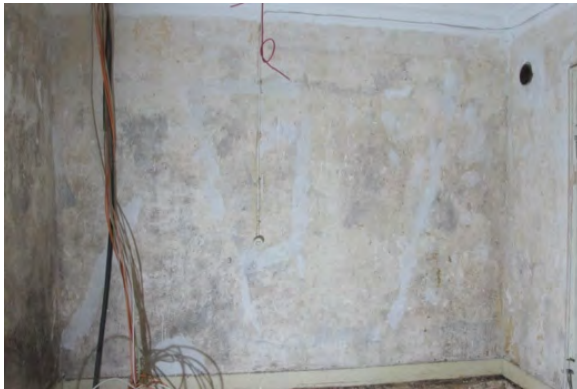
Foto 43: Raum 0.03, Wand a; nach Entfernung der Tapete (mit Schimmelbefall).
