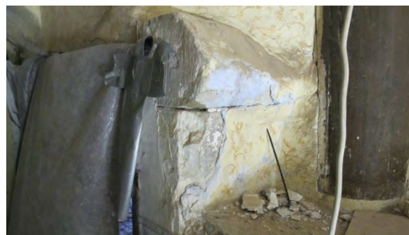
Foto 39: Raum 0.02, Wand d; Fehlstelle im Verputz.
