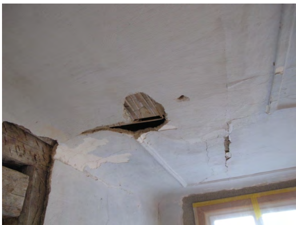
Foto 278: Raum 2.04, Decke; Fehlstelle in der Decke.
