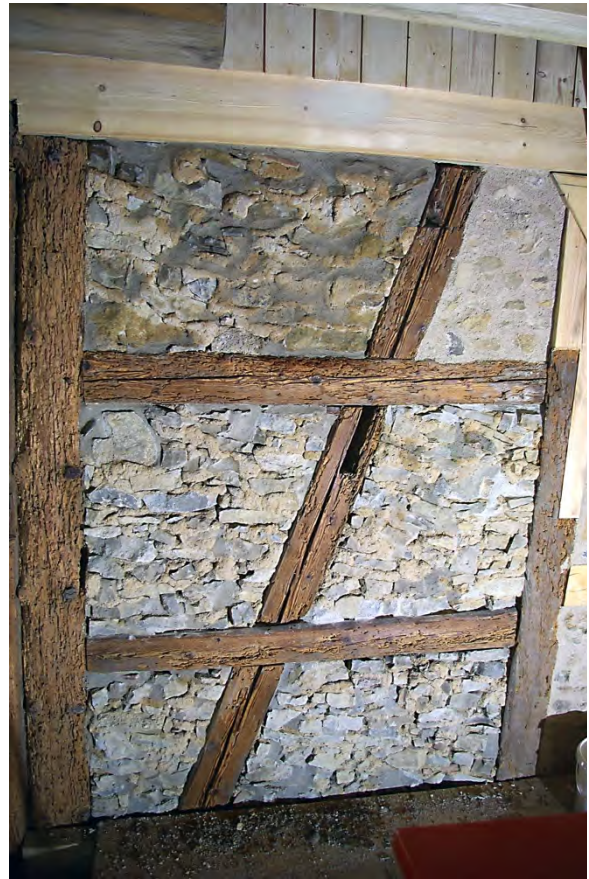
Foto 543: Raum 2.06, Wand c; ergänzte Fehlstellen im Gefach links oben.
