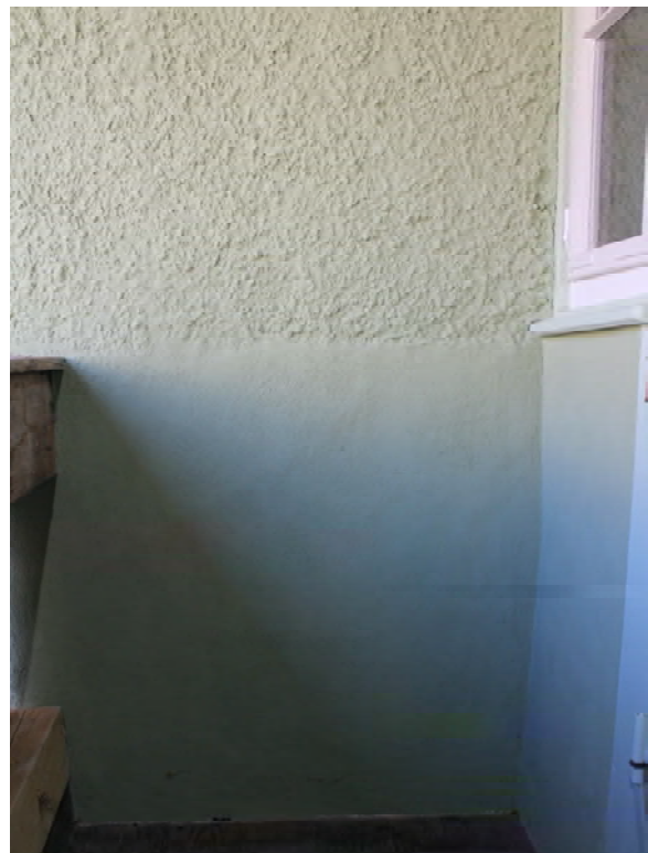
Foto 467: Raum 1.11, Wand b; Endzustand Fehlstelle.
