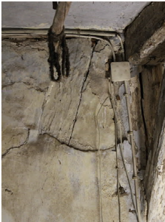
Foto 234: Raum 2.01, Wand d; aufliegende Verschmutzung und alte Elektroinstallationen.
