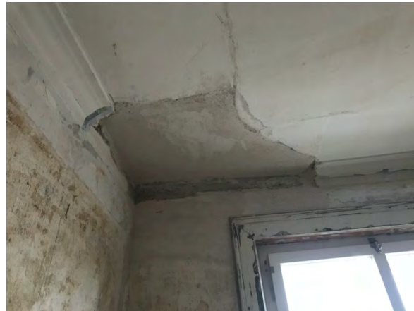
Foto 409: Raum 1.03, Wand b; Putzergänzungen.
