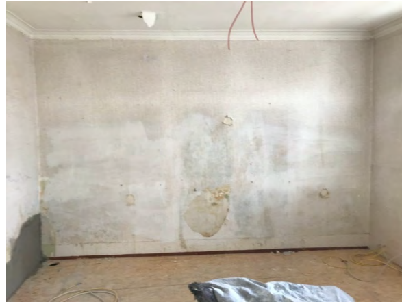
Foto 155: Raum 1.05, Wand b; Zustand vor Restaurierung.
