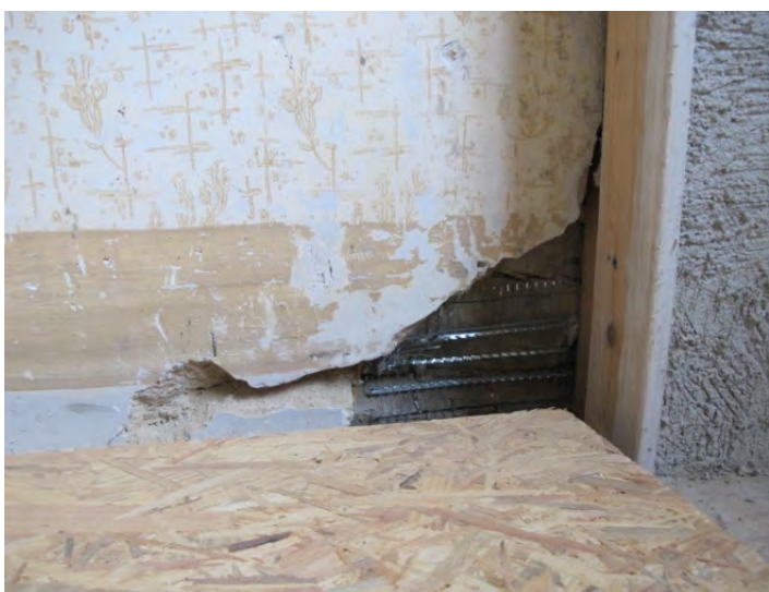
Foto 259: Raum 2.02, Wand c; Fehlstelle entstanden beim Abbruch des Kamins).
