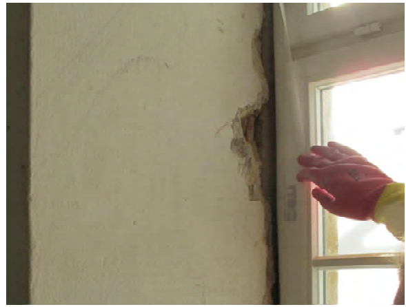
Foto 59: Raum 0.04, Wand c; Fehlstellen nach Einbau der neuen Fenster.
