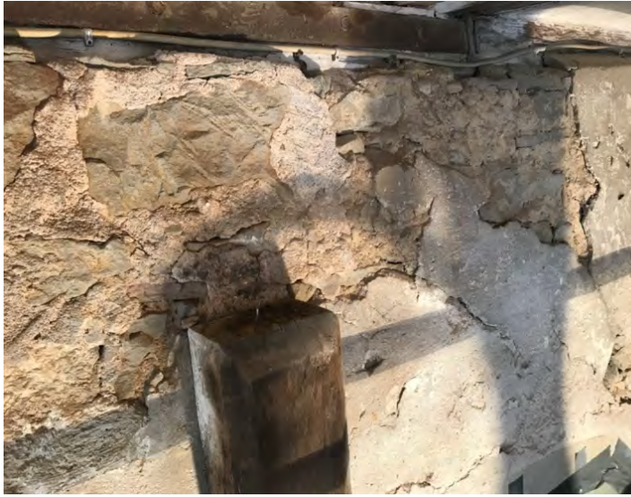
Foto 12: Durchfahrt (Raum 0.01, Wand b); Fehlstelle im Putz.
