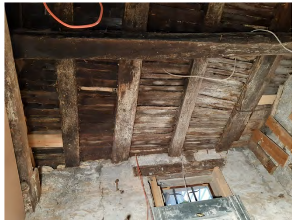
Foto 82: Raum 0.06, Decke; Zustand vor Restaurierung.
