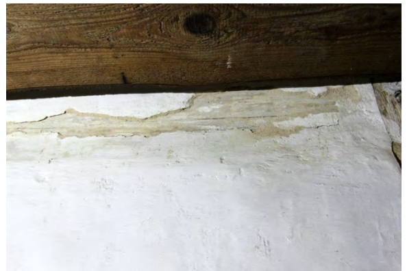
Foto 454: Raum 1.09, Wand b; Notsicherungen.
