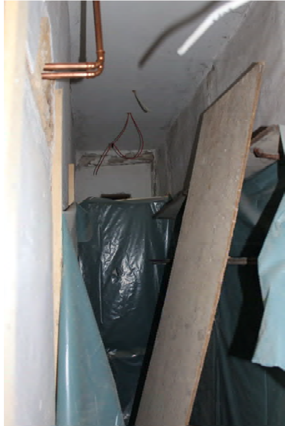
Foto 189: Raum 1.09, Wand a, b und c; Zustand vor Restaurierung.
