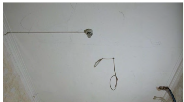
Foto 48: Raum 0.03, Decke; Zustand vor Restaurierung.
