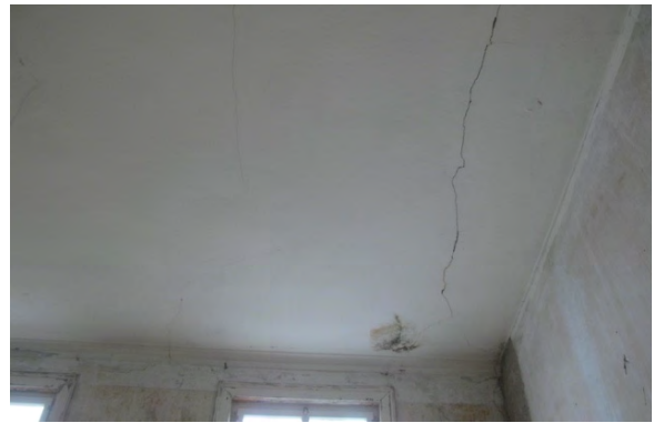
Foto 133: Raum 1.03, Decke; Zustand vor Restaurierung.
