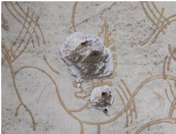
Foto 36: Raum 0.02, Wand a; Putzfehlstelle im oberen Wandbereich.
