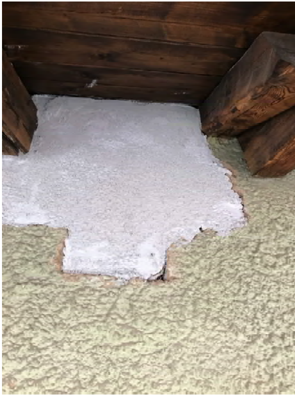
Foto 216: Raum 1.11, Wand c; Fehlstellen im Oberputz.
