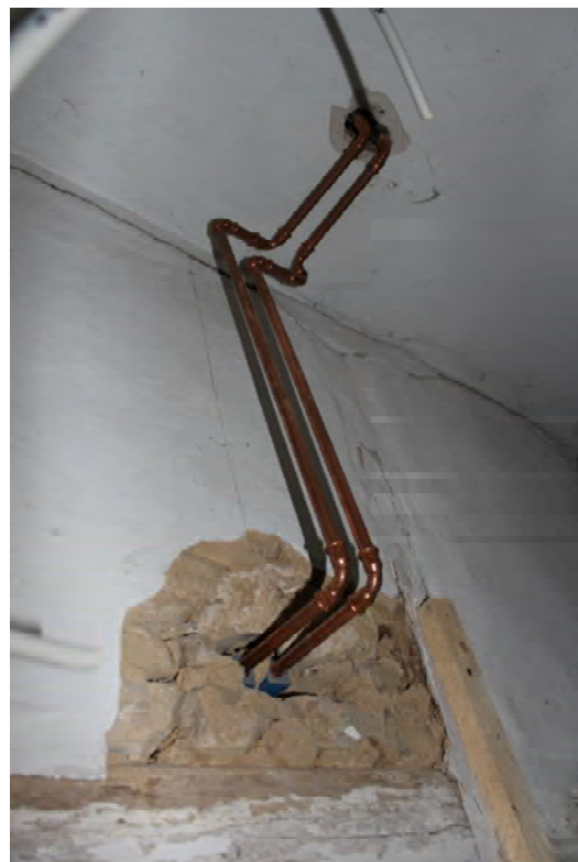
Foto 195: Raum 1.09; Wand d; Fehlstelle durch Neuproduktionen.
