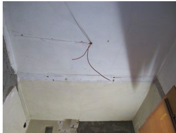
Foto 181: Raum 1.07 und 1.08, Decke; Zustand vor Restaurierung.
