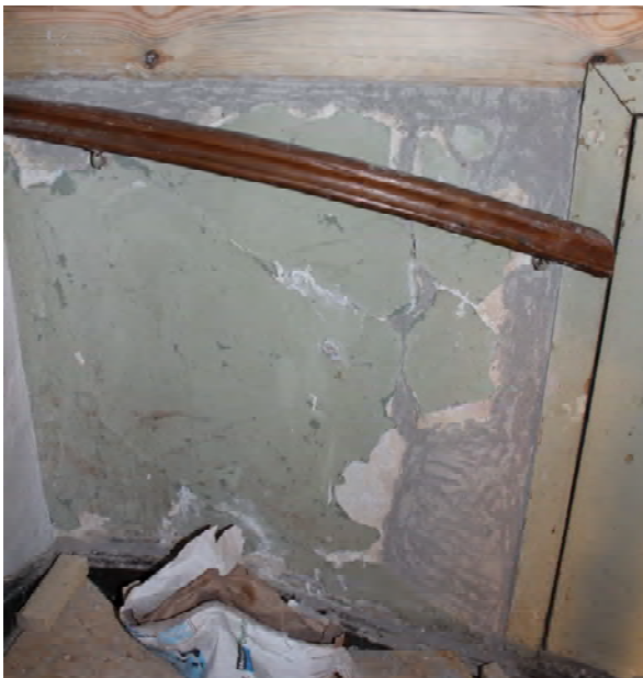
Foto 321: Raum 0.02, Wand a; konsolidierte und verputzte Fehlstellen.
