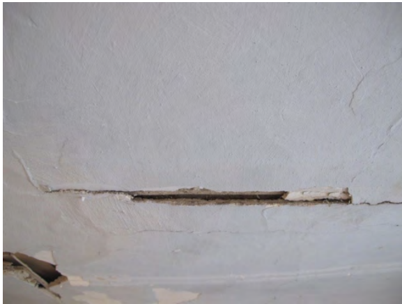
Foto 280: Raum 2.04, Decke; Riss.
