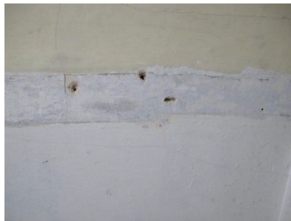
Foto 183: Raum 1.07 und 1.08, Decke; Löcher im Bereich der entfernten Wand.
