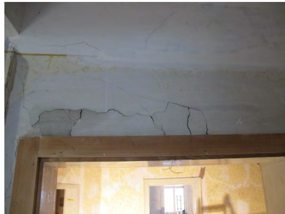
Foto 206: Raum 1.10, Wand b; lose Putzbereiche über Tür.
