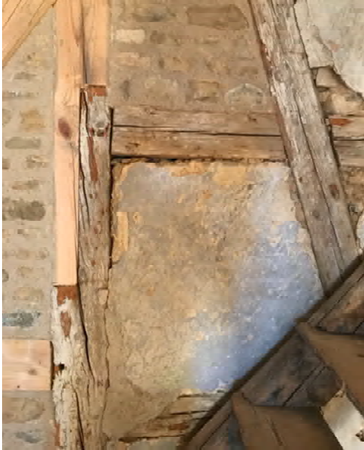
Foto 228: Raum 2.01, Wand a; Zustand vor Restaurierung.
