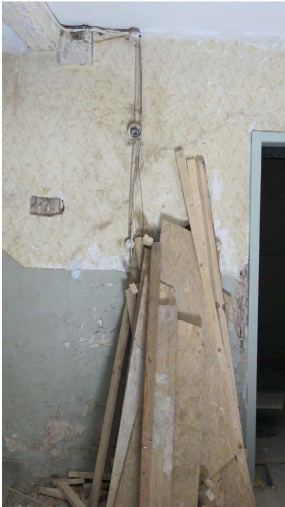
Foto 30: Raum 0.02, Wand a; Zustand vor Restaurierung.
