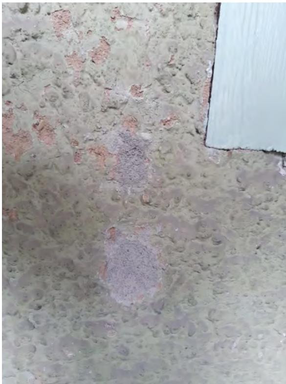
Foto 470: Raum 1.11, Wand c; geschlossene Fehlstelle.
