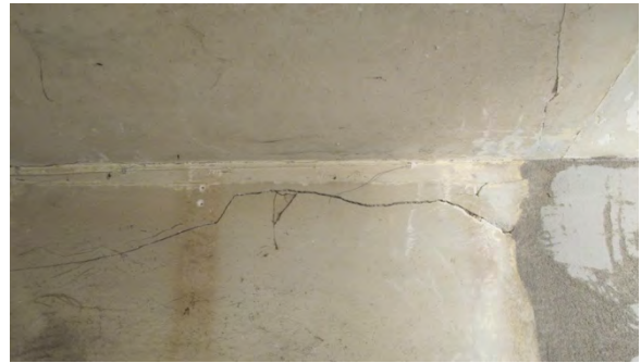
Foto 170: Raum 1.06, Wand b; Risse unterhalb der Decke.
