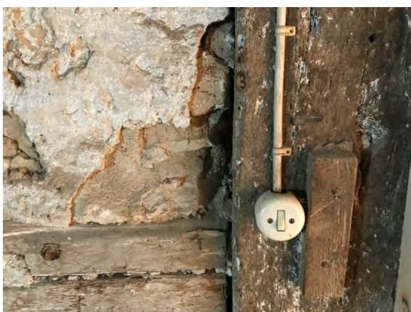
Foto 83: Raum 0.06, Wand c; Fehlstelle im Oberputz und Elektroleitung mit Schalter.
