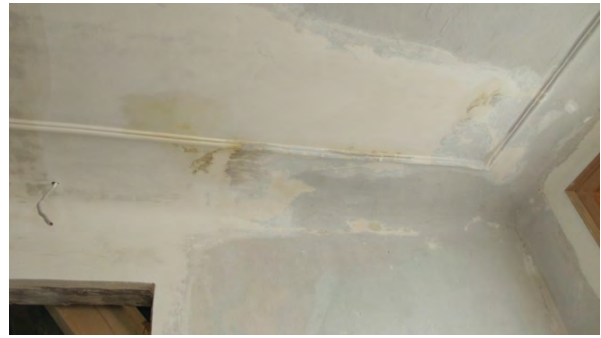
Foto 524: Raum 2.04, Wand c, d und Decke; Ergänzung mit bräunlicher Ausblühung.
