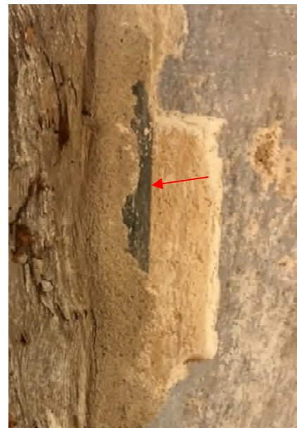
Foto 491: Detail aus Foto 490 mit Erstfassung (Pfeil).
