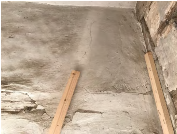
Foto 451: Raum 1.09, Wand a; aufstehende Farbschollen.
