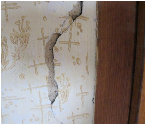
Foto 257: Raum 2.02, Wand a; aufstehender Verputz.
