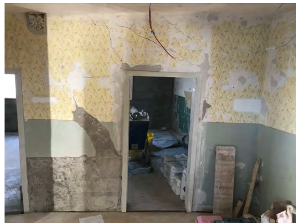
Foto 105: Raum 1.01, Wand b; Zustand vor Restaurierung.
