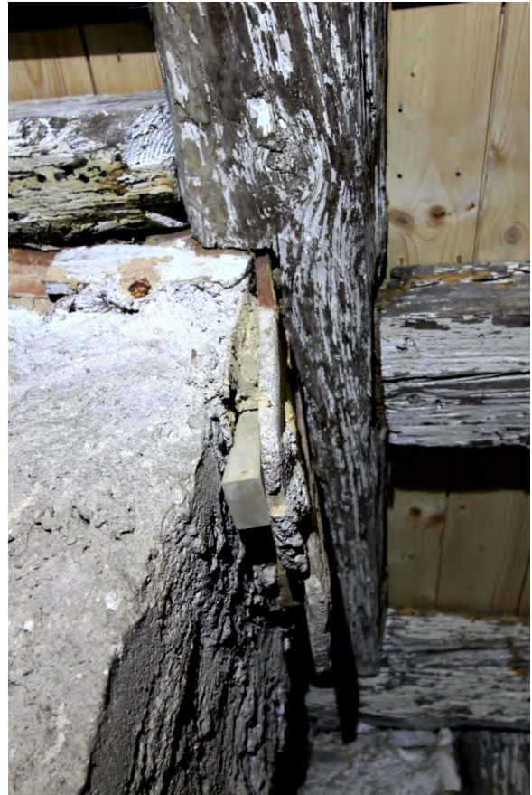
Foto 538: Raum 2.05, Wand d; Sicherung Bieberschwanzziegel.
