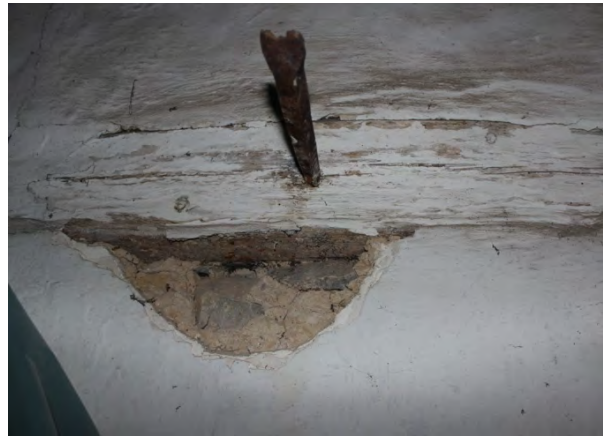
Foto 193: Raum 1.09; Wand b; Fehlstelle im Putz des Gefachs.
