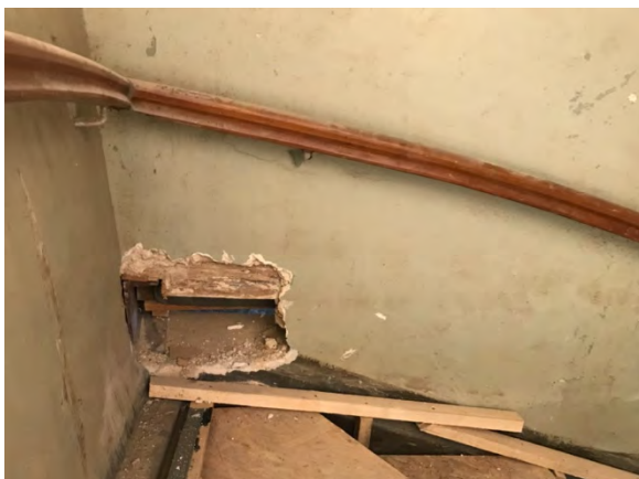
Foto 108: Raum 1.01, Wand d; Fehlstelle im Mauerwerk.
