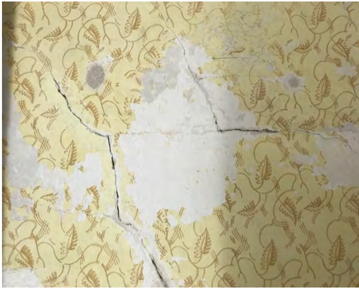
Foto 110: Raum 1.01, Wand b; Rissbildung und Fassungsfehlstellen.
