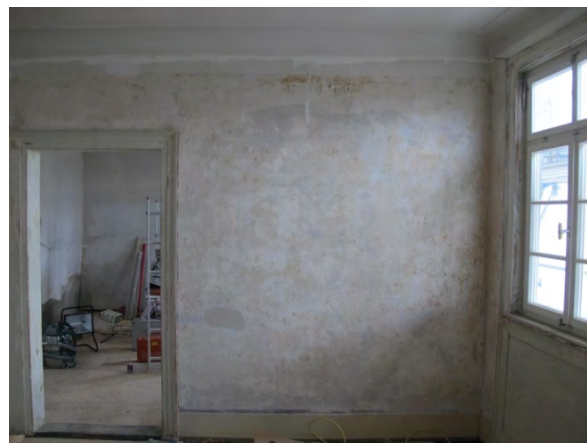
Foto 142: Raum 1.04, Wand b; nach Abnahme der Tapete.
