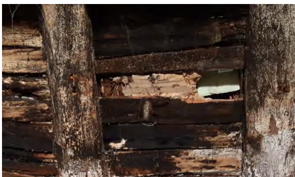
Foto 358: Raum 0.06, Decke; Vorzustand Fehlstelle.
