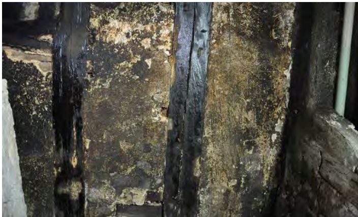
Foto 67: Raum 0.05, Decke; Zustand vor Baumaßnahme.
