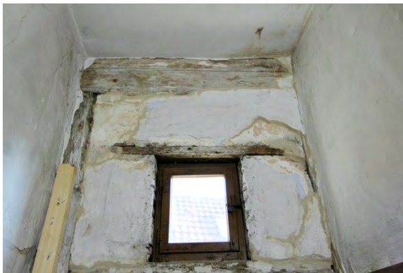
Foto 453: Raum 1.09, Wand c; Notsicherungen.
