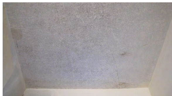
Foto 441: Raum 1.07/1.08, Decke; Schimmelbefall nach Fassungsabnahme.
