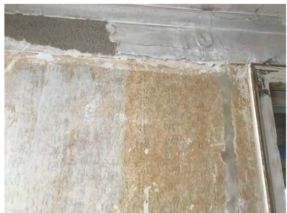
Foto 122: Raum 1.02, Wand a; Risse und Fehlstellen in Stuckierung.
