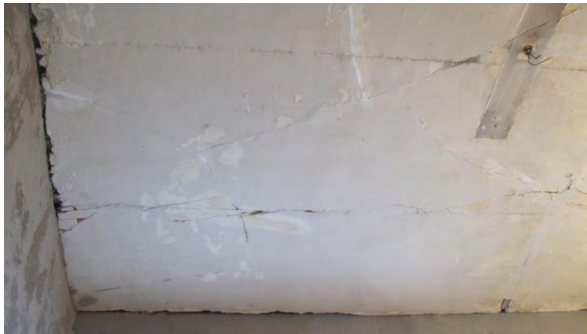
Foto 169: Raum 1.06, Decke; Rissbild.
