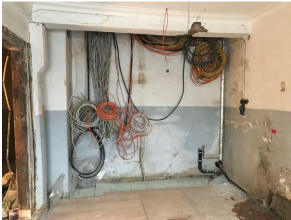
Foto 52: Raum 0.04, Wand a; Zustand vor Restaurierung.
