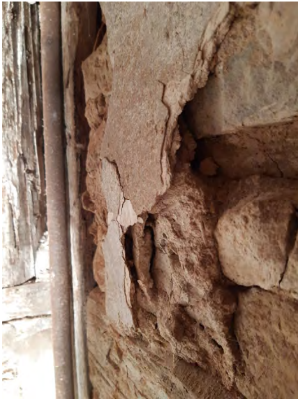
Foto 72: Detail aus Foto 68; Hohl liegende Putz- und Fasungslagen.
