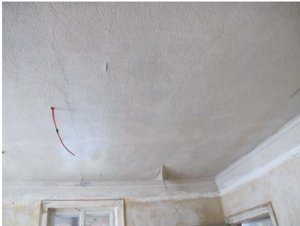
Foto 123: Raum 1.02, Decke; Zustand vor Restaurierung.
