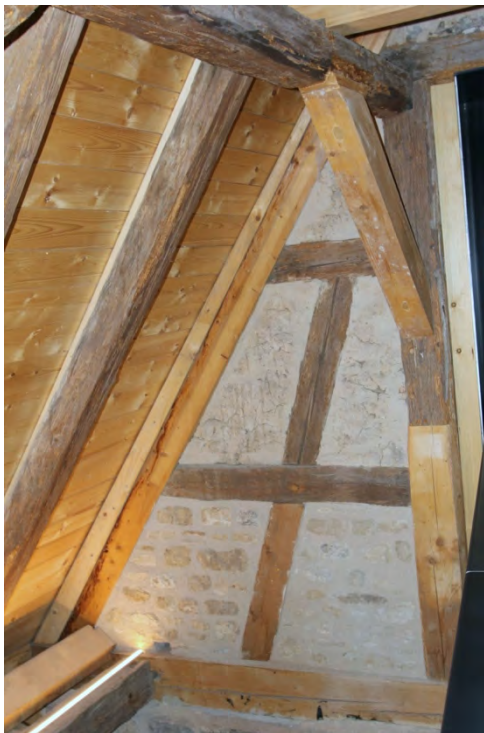
Foto 548: Raum 2.06, Wand a, unten links; Endzustand.
