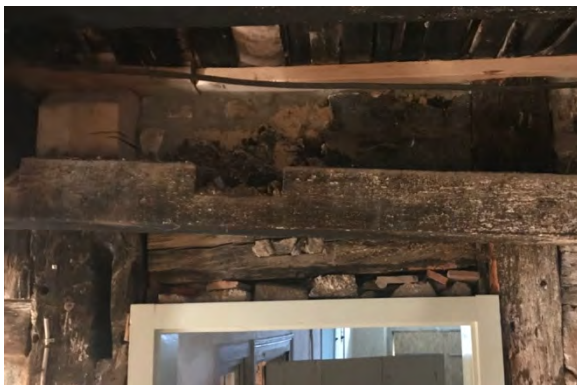
Foto 362: Raum 0.06, Wand c; Vorzustand, lose Steine über dem Türsturz.
