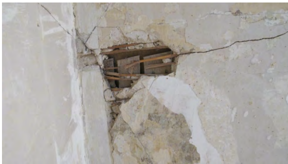
Foto 171: Raum 1.06, Decke; Mörtelfehlstelle.
