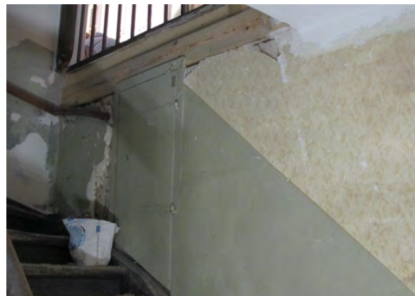
Foto 29: Raum 0.02, Wand a; Zustand vor Restaurierung.
