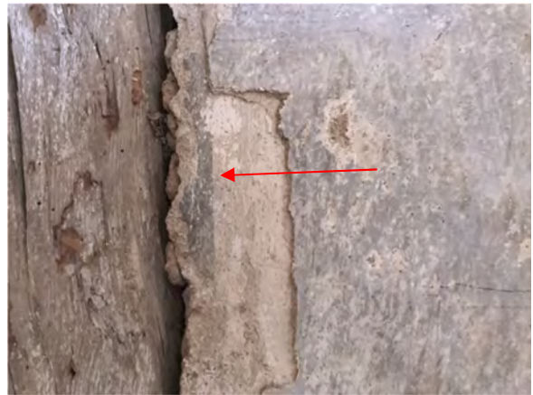
Foto 239: Raum 2.01, Wand a; Pfeil: Erstputzlage 16. Jh..
