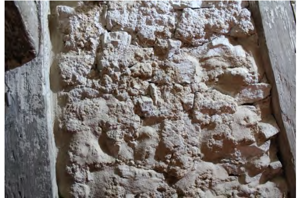
Foto 533: Raum 2.05, Wand d; Ergänzte Fehlstellen / Streiflichtaufnahme.
