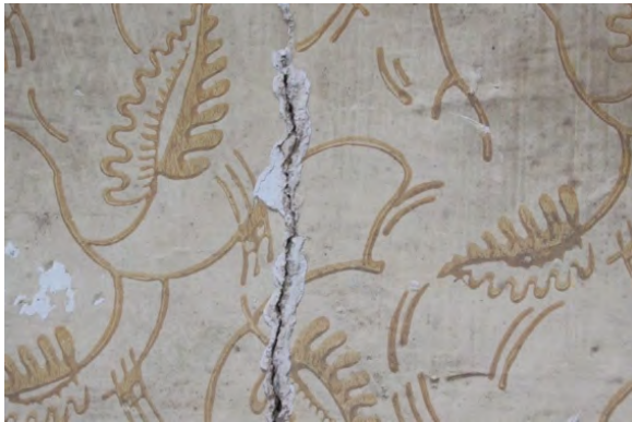
Foto 34: Raum 0.02, Wand a; Riss im oberen Wandbereich.
