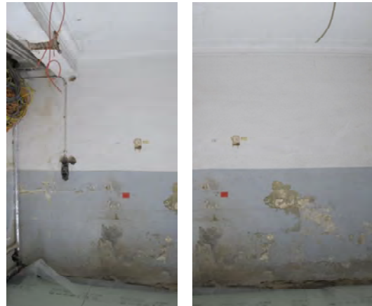
Foto 53: Raum 0.04, Wand b; Zustand vor Restaurierung.
