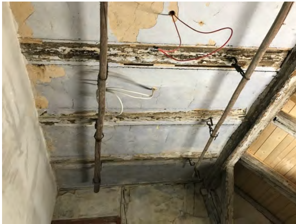
Foto 232: Raum 2.01, Decke; Zustand vor Restaurierung.
