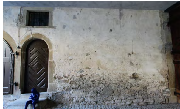
Foto 304: Raum 0.01, Wand b rechts; Endzustand.
