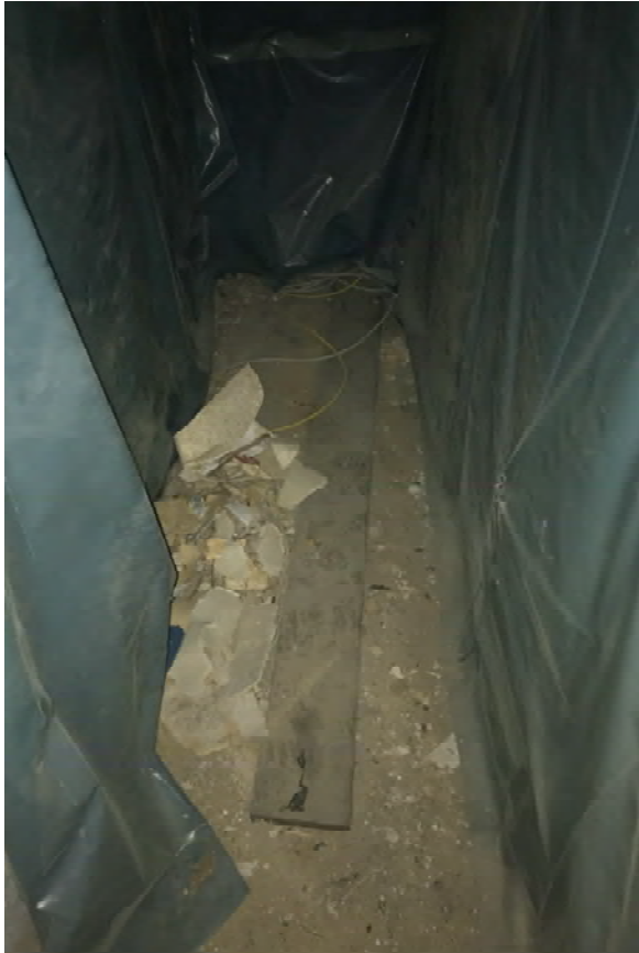
Foto 188: Raum 1.09, Wand a, b und c; Zustand vor Restaurierung.
