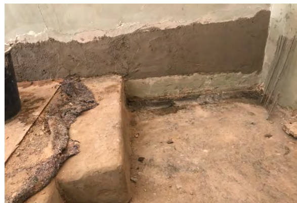
Foto 310: Raum 0.02, Wand d; Fehlstelle im Bereich des Schwellenbalkens mit angetragenem Oberputz.
