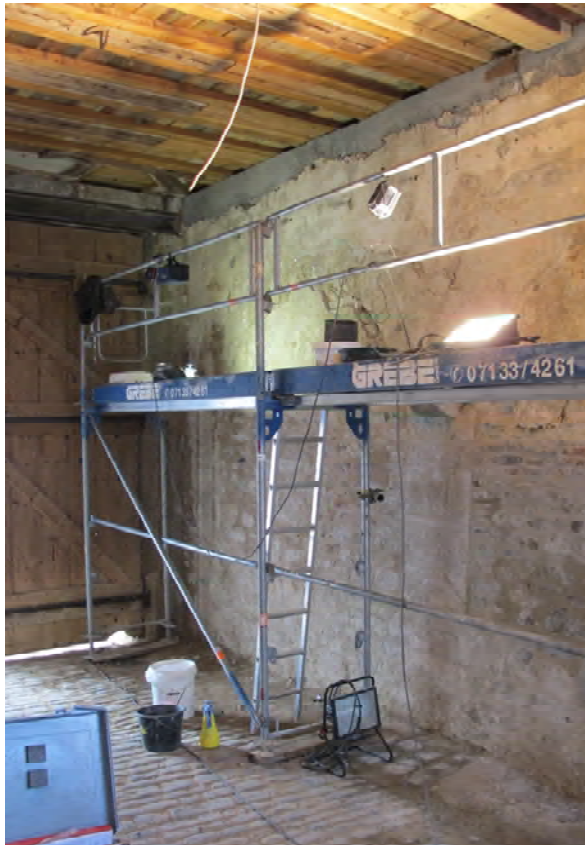
Foto 8: Durchfahrt (Raum 0.01, Wand d), Zustand vor Restaurierung.
