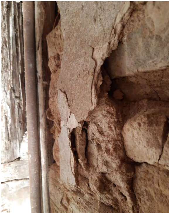
Foto 350: Raum 0.05, Wand a; hohlliegendes Gefach.
