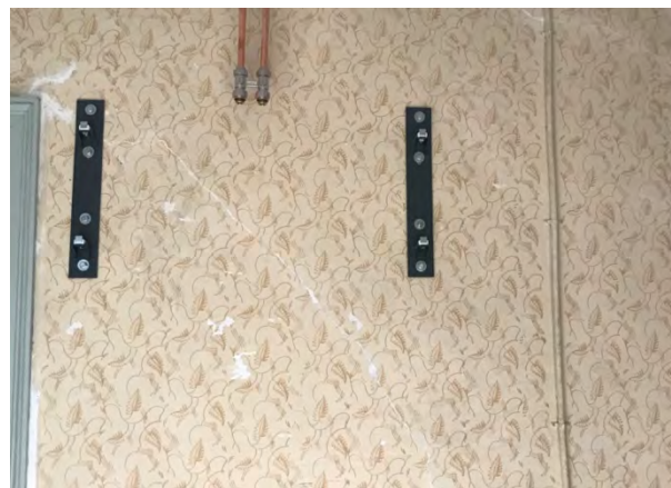
Foto 314: Raum 0.02, Wand b; geschlossene Risse.
