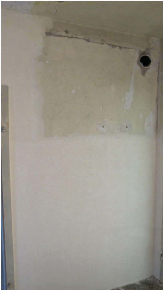
Foto 442: Raum 1.07/1.08, Wand c; großflächige Verputzung und geschlossene Risse.
