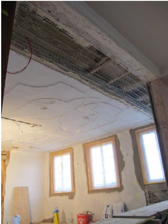
Foto 276: Raum 2.04, Wand b, c und Decke; Zustand vor Restaurierung.
