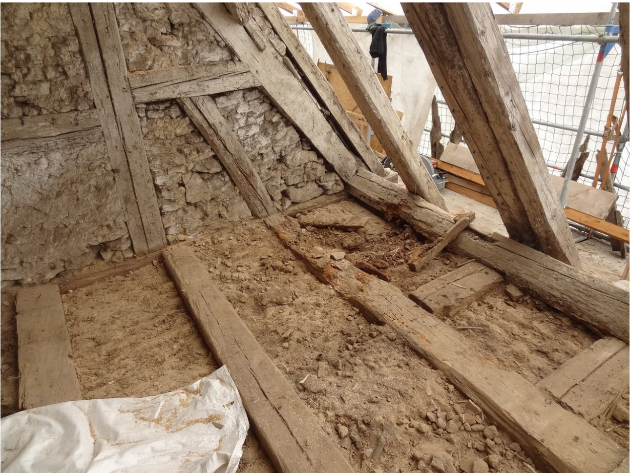
Feuchteschäden Decke und Fußpunkte der Dachkonstruktion
