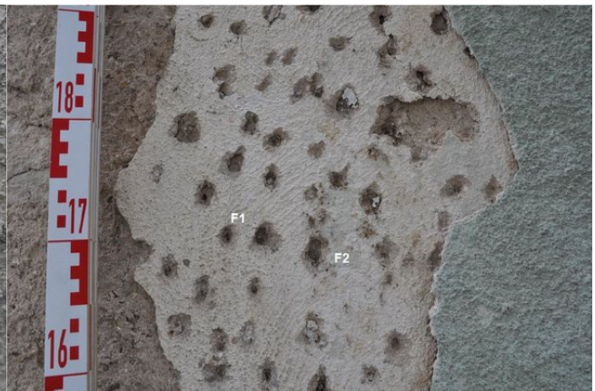
Ostfassade Südlicher Bereich Abb. 2: Putzablösungen im südlichen Bereich der Ostfassade; (Feldtkeller, 02.08.2016)
