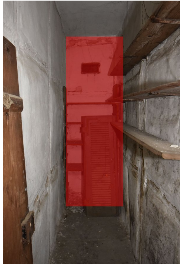
Frontalansicht Wand d, Raum 1.09, mit Blickrichtung Westen; Kartierung der im Original zu erhaltenden Bereiche in dunkelrot;
