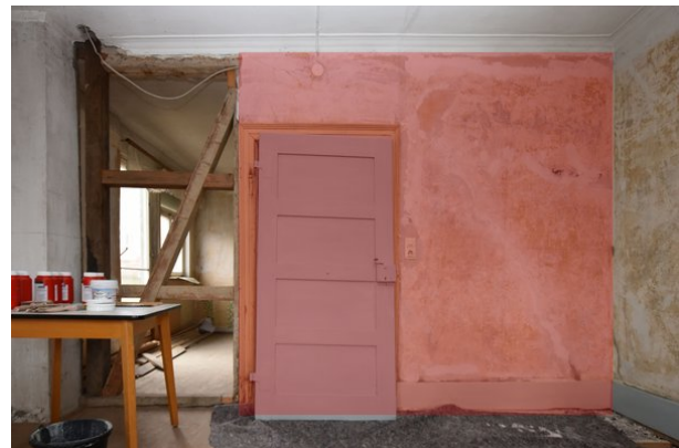
Frontalansicht Wand a, Raum 1.03, mit Blickrichtung Norden; Kartierung der besonders sensiblen Bereiche in rot;
