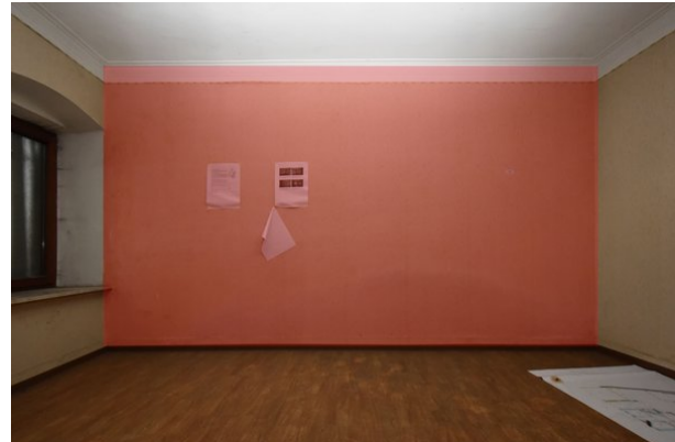
Frontalansicht Wand d, Raum 0.03, mit Blickrichtung Westen; Kartierung der besonders sensiblen Bereiche in rot;
