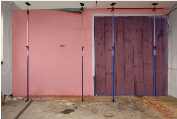
Frontalansicht Wand d, Raum 2.04, mit Blickrichtung Westen; Kartierung der besonders sensiblen Bereiche in rot; Kartierung der zur Veränderung vorgesehenen Bereiche in blau;
