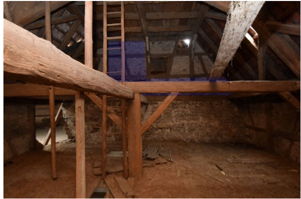
Frontalansicht Wand a, Raum 2.06, mit Blickrichtung Norden; Kartierung der zur Veränderung vorgesehenen Bereiche in blau;
