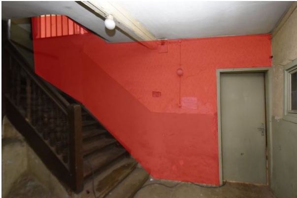
Frontalansicht Wand a, Raum 0.02, mit Blickrichtung Norden; Kartierung der im Original zu erhaltenden Bereiche in dunkelrot;
