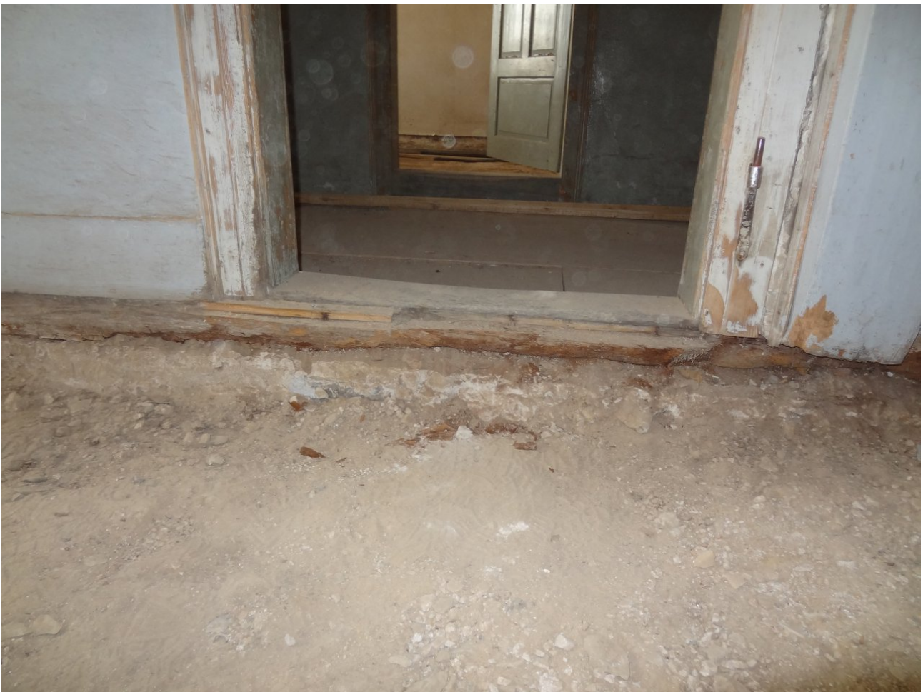
Ansicht Wand d (Wand zu Raum 0.02, Flur): schadhafte Fachwerkschwelle
