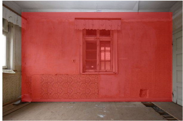
Frontalansicht Wand a, Raum 1.02, mit Blickrichtung Norden; Kartierung der im Original zu erhaltenden Bereiche in dunkelrot;
