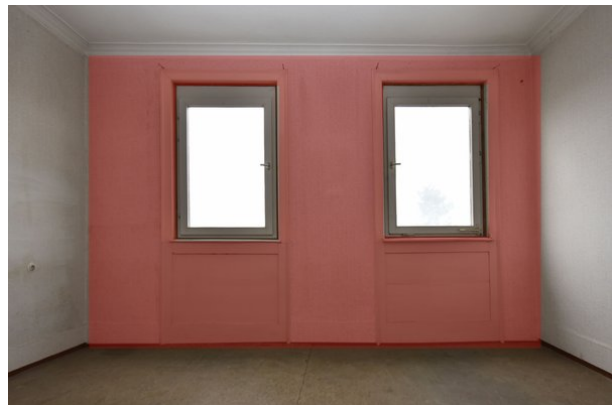
Frontalansicht Wand c, Raum 1.05, mit Blickrichtung Süden; Kartierung der besonders sensiblen Bereiche in rot;
