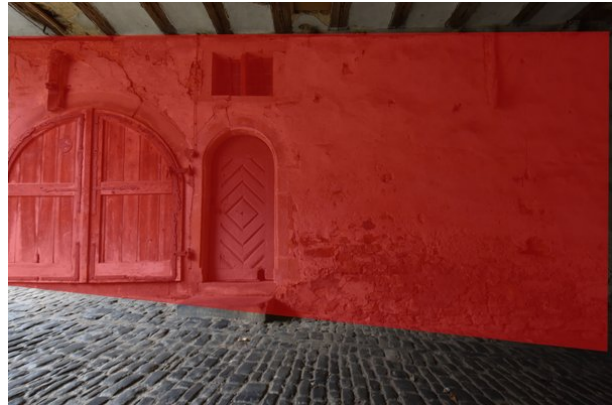
Frontalansicht Wand b, Raum 0.01, mit Blickrichtung Osten; Kartierung der im Original zu erhaltenden Bereiche in dunkelrot;
