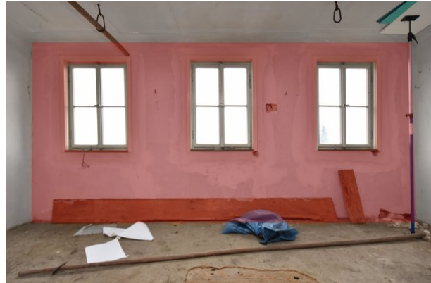
Frontalansicht Wand c, Raum 2.04, mit Blickrichtung Süden; Kartierung der besonders sensiblen Bereiche in rot;
