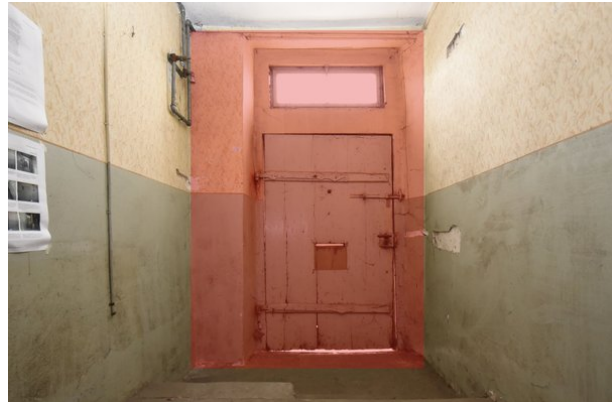
Frontalansicht Wand c, Raum 0.02, mit Blickrichtung Süden; Kartierung der besonders sensiblen Bereiche in rot;
