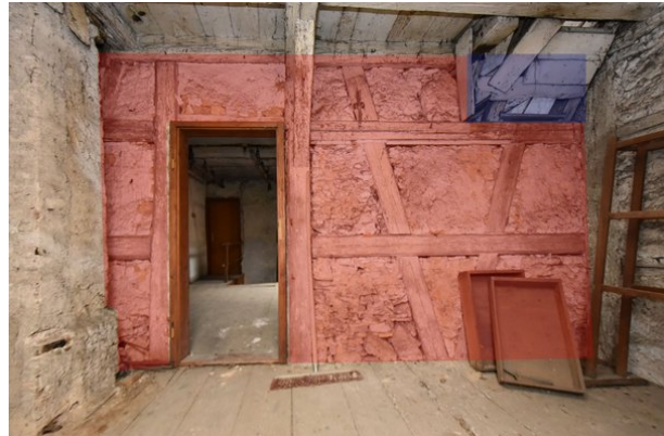
Frontalansicht Wand d (nördlicher Teil), Raum 2.05, mit Blickrichtung Westen; Kartierung der besonders sensiblen Bereiche in rot; Kartierung der zur Veränderung vorgesehenen Bereiche in blau;
