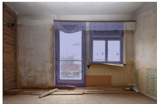
Frontalansicht Wand d, Raum 1.02, mit Blickrichtung Westen; Kartierung der zur Veränderung vorgesehenen Bereiche in blau;
