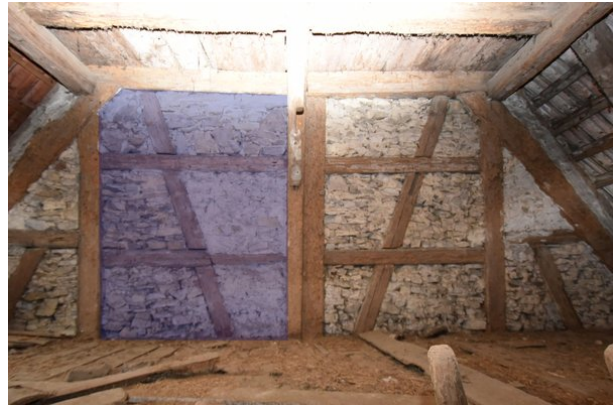
Frontalansicht Wand c (oberer Bereich), Raum 2.06, mit Blickrichtung Süden; Kartierung der zur Veränderung vorgesehenen Bereiche in blau;
