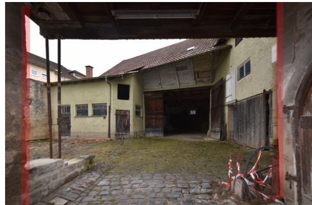
Frontalansicht Wand a, Raum 0.01, mit Blickrichtung Norden; Kartierung der besonders sensiblen Bereiche in rot;
