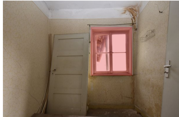
Frontalansicht Wand d, Raum 1.10, mit Blickrichtung Osten; Kartierung der besonders sensiblen Bereiche in rot;
