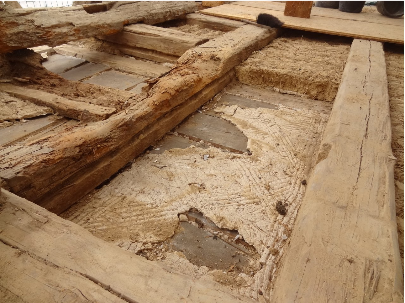
Feuchteschäden Decke und Fußpunkte der Dachkonstruktion
