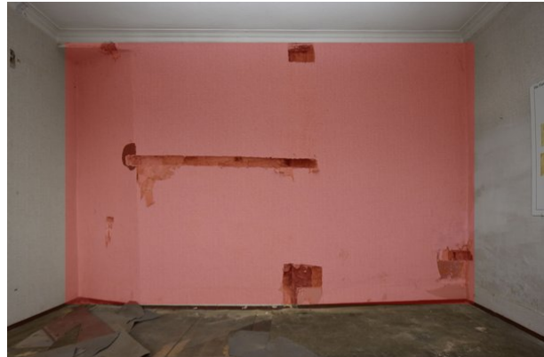
Frontalansicht Wand a, Raum 1.05, mit Blickrichtung Norden; Kartierung der besonders sensiblen Bereiche in rot;
