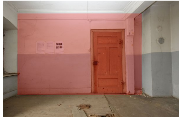
Frontalansicht Wand d, Raum 0.04, mit Blickrichtung Westen; Kartierung der besonders sensiblen Bereiche in rot;
