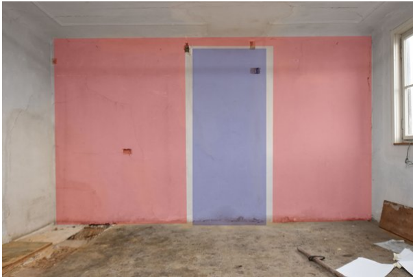
Frontalansicht Wand b, Raum 2.04, mit Blickrichtung Osten; Kartierung der besonders sensiblen Bereiche in rot; Kartierung der zur Veränderung vorgesehenen Bereiche in blau;
