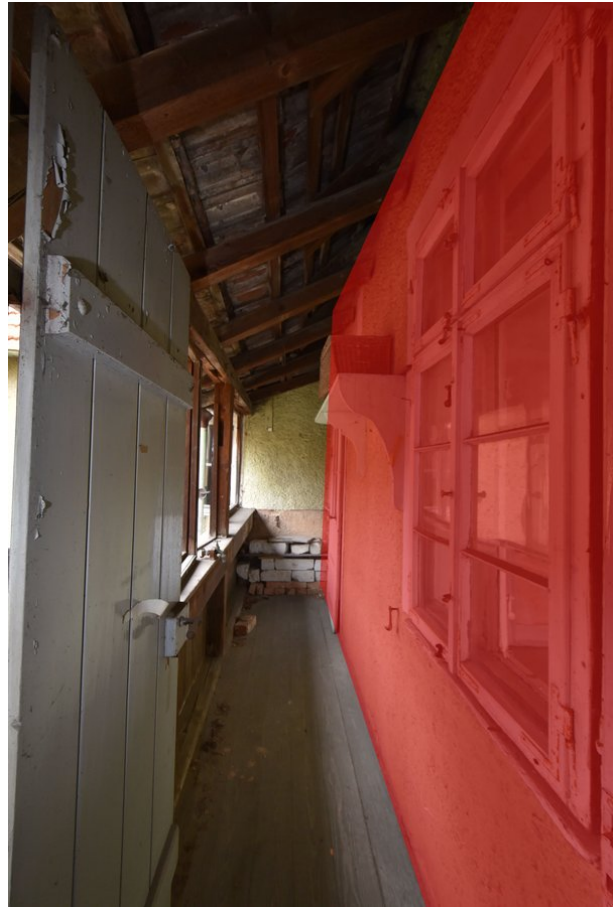
Frontalansicht Wand b, Raum 1.11, mit Blickrichtung Osten und Schrägansicht von Wand c; Kartierung der im Original zu erhaltenden Bereiche in dunkelrot;
