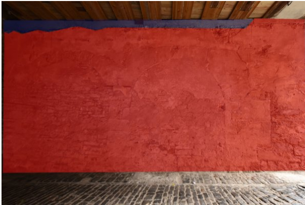
Frontalansicht Wand d, Raum 0.01, mit Blickrichtung Westen; Kartierung der besonders sensiblen Bereiche in rot; Kartierung der zur Veränderung vorgesehenen Bereiche in blau;
