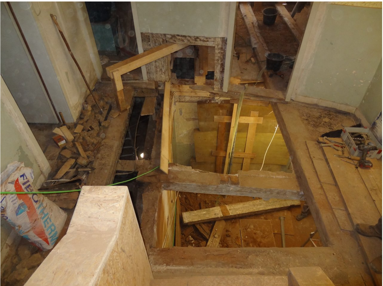
Schäden Decke über Raum EG0.02 Treppenhaus
