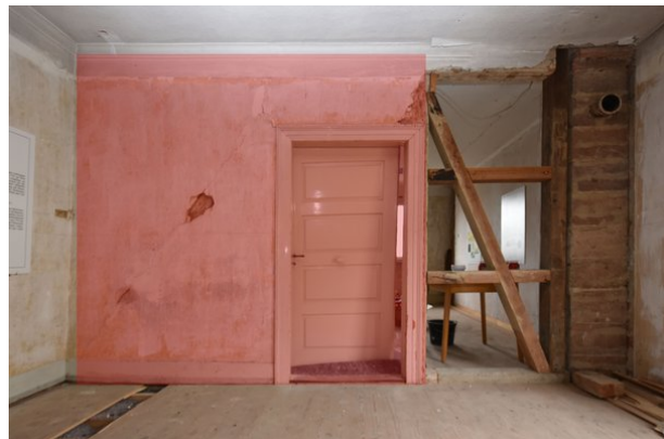
Frontalansicht Wand c, Raum 1.02, mit Blickrichtung Süden; Kartierung der besonders sensiblen Bereiche in rot;
