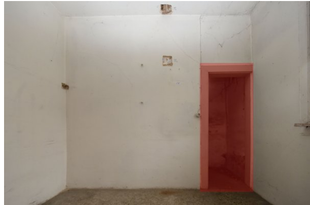
Frontalansicht Wand a, Raum 1.07, mit Blickrichtung Norden; Kartierung der besonders sensiblen Bereiche in rot;
