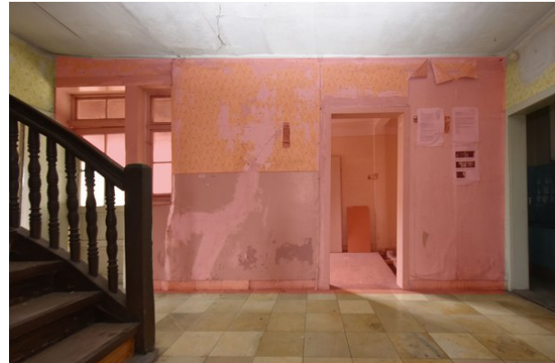
Frontalansicht Wand a, Raum 1.01, mit Blickrichtung Norden; Kartierung der besonders sensiblen Bereiche in rot;
