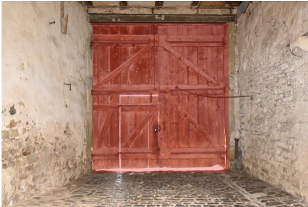
Frontalansicht Wand c, Raum 0.01, mit Blickrichtung Süden; Kartierung der besonders sensiblen Bereiche in rot;
