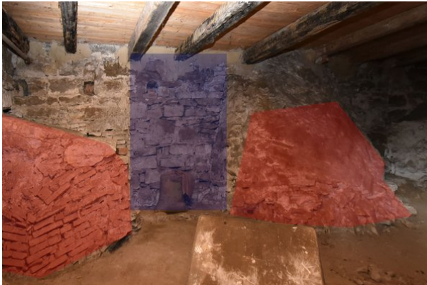
Frontalansicht Wand a, Raum 0.09, mit Blickrichtung Norden; Kartierung der besonders sensiblen Bereiche in rot; Kartierung der zur Veränderung vorgesehenen Bereiche in blau;
