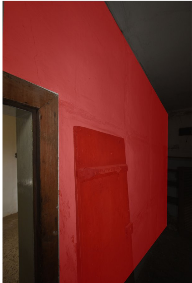
Frontalansicht Wand c, Raum 1.09, mit Blickrichtung Süden; Kartierung der im Original zu erhaltenden Bereiche in dunkelrot;
