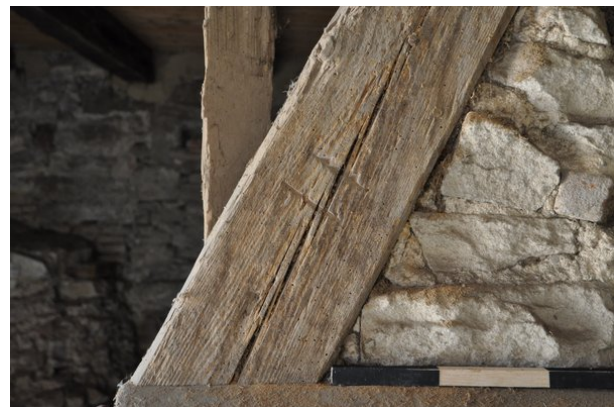
Raum 0.08a, Detailansicht der Abbundzeichen an Wand a mit Blickrichtung Norden (strebewerk. 13.08.2015)
