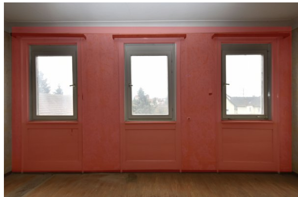
Frontalansicht Wand c, Raum 1.04, mit Blickrichtung Süden; Kartierung der besonders sensiblen Bereiche in rot;
