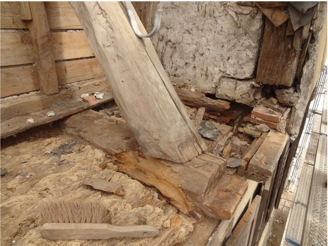
Schäden Decke über Raum OG1.03. Liegende Zapfen zum Anschließen des profilierten Gesimsbalkens
