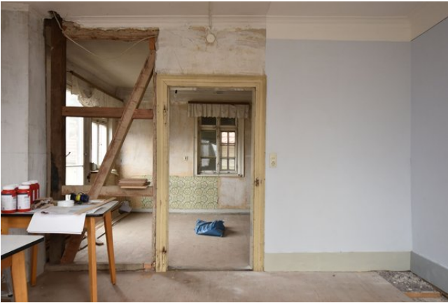
Frontalansicht Wand a, Raum 1.03, mit Blickrichtung Norden; Wand mit Bemusterungsflächen (hellgrau);
