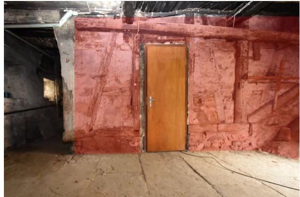
Frontalansicht Wand c, Raum 0.06, mit Blickrichtung Süden; Kartierung der besonders sensiblen Bereiche in rot;
