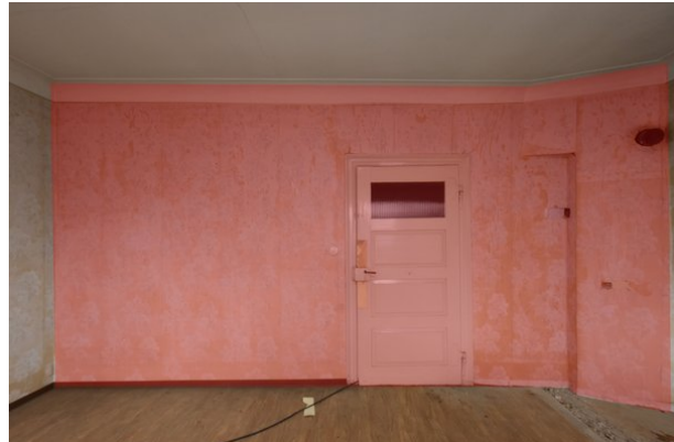
Frontalansicht Wand a, Raum 1.04, mit Blickrichtung Norden; Kartierung der besonders sensiblen Bereiche in rot;
