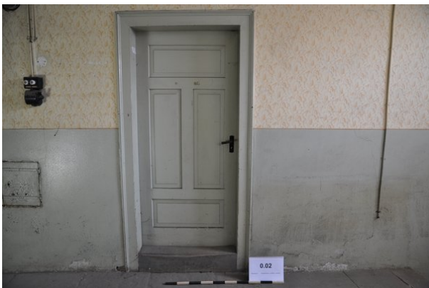
Raum 0.02b, Detailansicht der südlichen Tür der Ostwand zu Raum 0.04 mit Blickrichtung Osten (strebewerk. 13.08.2015)
