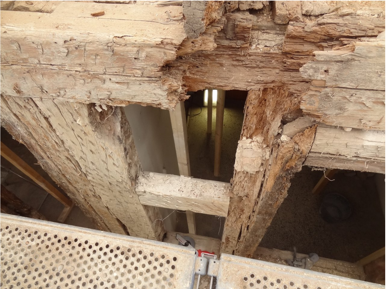
Massive Schäden an den Hölzern der Fachwerkaußenwand
