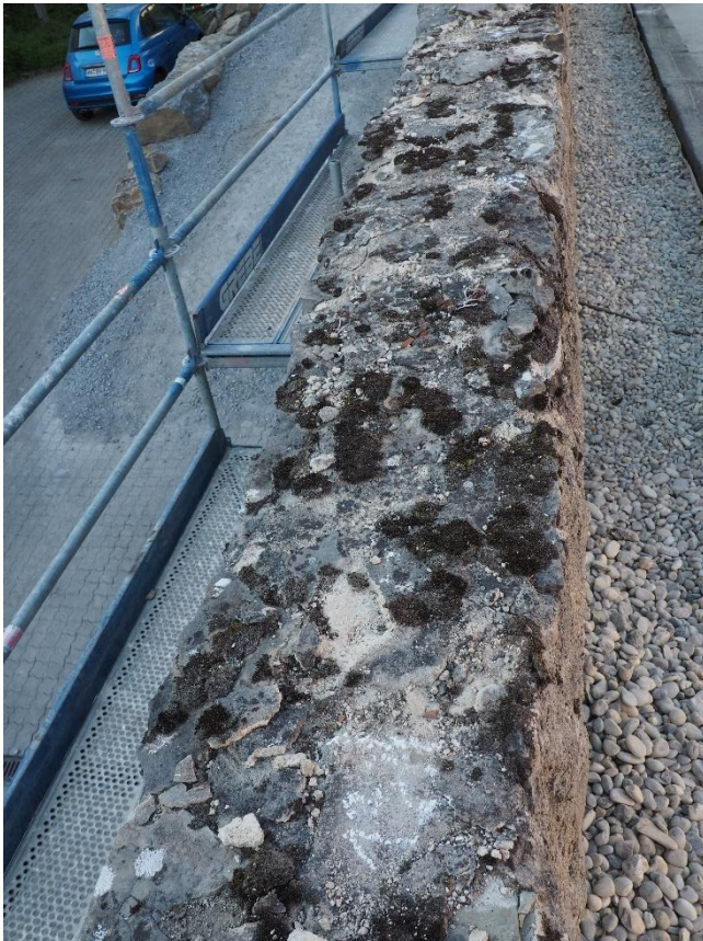
12,00 bis 13,00 m Mauersteine teilweise aufgewittert
