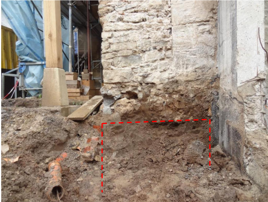
Bild 41 Westliche Mauerwerkswand der Hofdurchfahrt nicht ausreichend tief gegründet. Dadurch wurden im Bereich nördlich des neuen Technikgebäudes Unterfangungsmaßnahmen erforderlich (siehe Bild 42).
