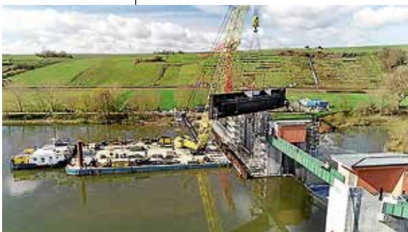
Einhub des Verschlusses am Wehr Horkheim
